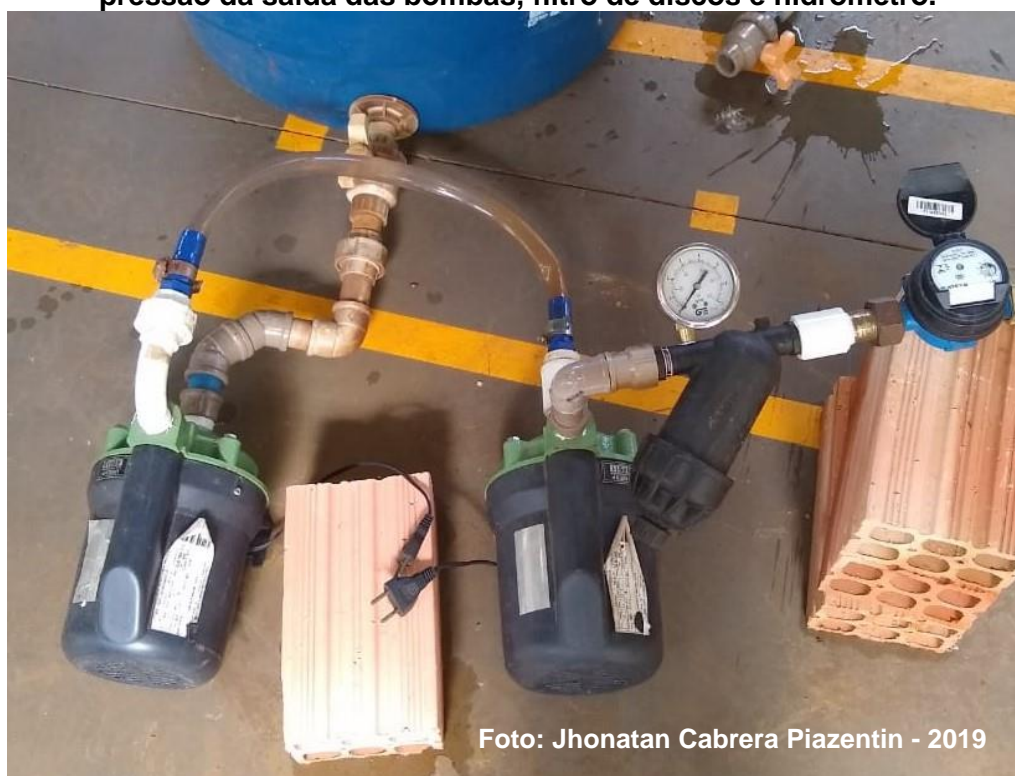
Figura 3 - Moto-bombas centrífugas Schneider BCR-2000, manômetro de controle de pressão da saída das bombas, filtro de discos e hidrômetro.
