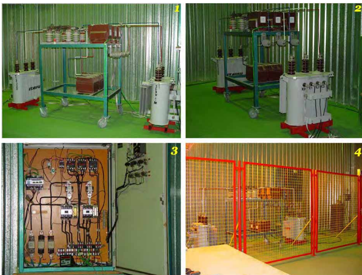
Figura 22 – Fotografias da subestação experimental
