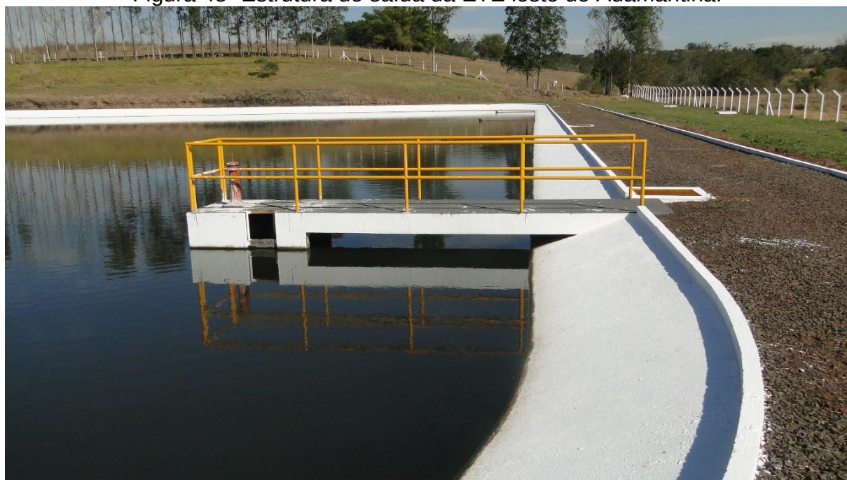
Figura 48- Estrutura de saída da ETE leste de Adamantina.
