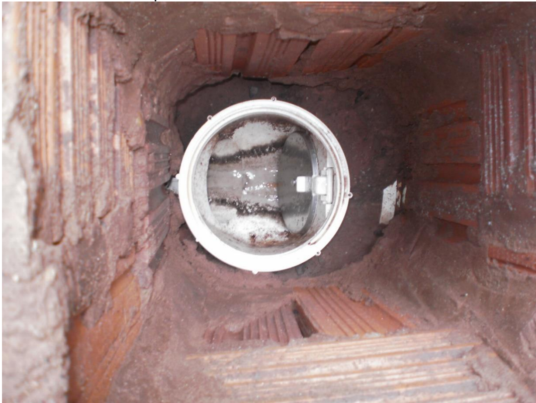
Figura 30 - Válvula de retenção, tipo “flap” que impede as águas pluviais de retornarem para o interior dos imóveis.
