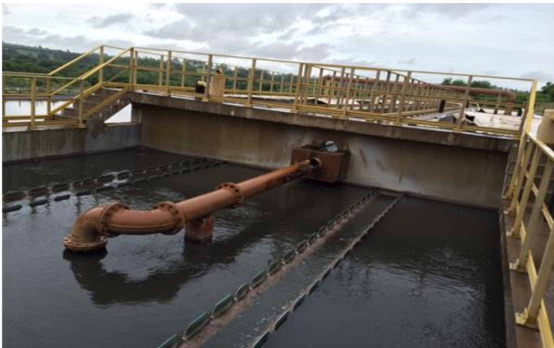
Figura 11- Vista do filtro anaeróbio associado ao RAFA da ETE oeste de Adamantina.
