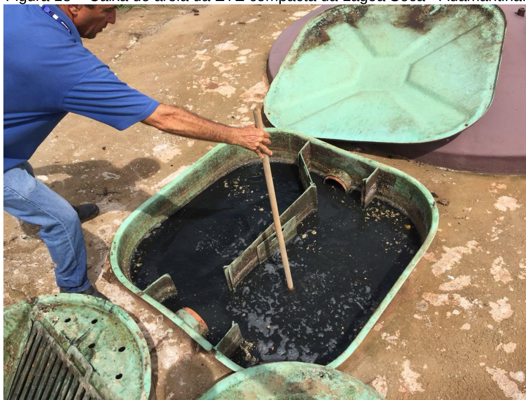
Figura 18 – Caixa de areia da ETE compacta da Lagoa Seca - Adamantina.
