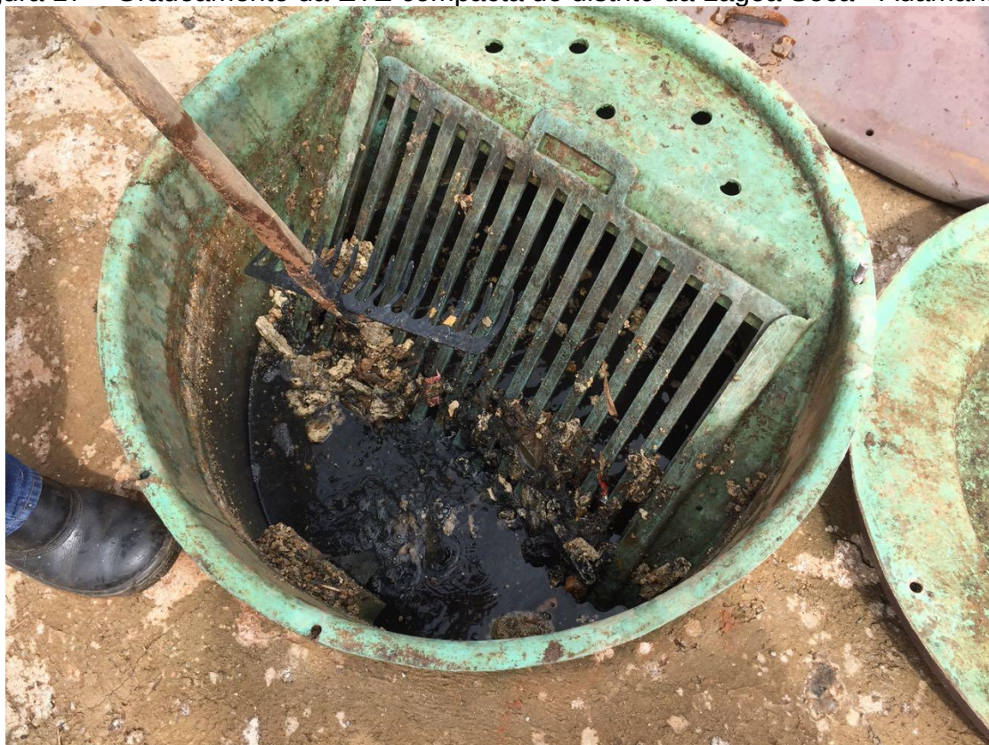
Figura 17 – Gradeamento da ETE compacta do distrito da Lagoa Seca - Adamantina.
