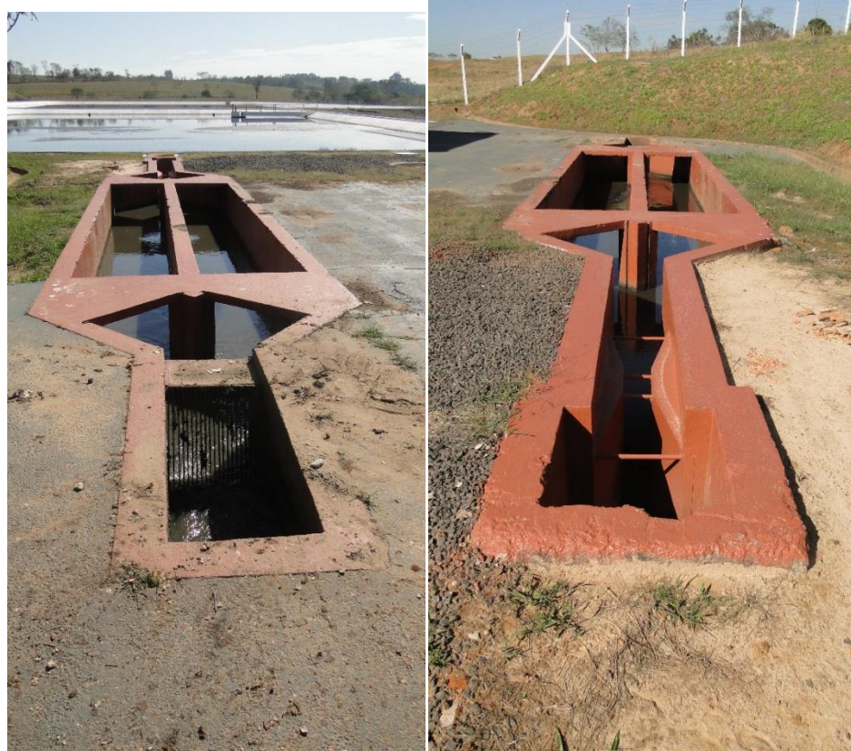
Figura 3 - Gradeamento de resíduos sólidos e caixas de areia e aspecto da calha “Parshall” da ETE leste de Adamantina.
