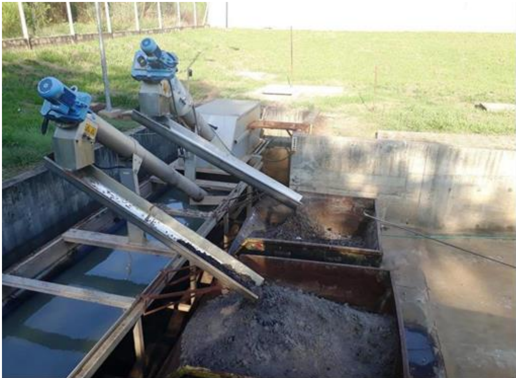
Figura 7- Peneiras rotativas autolimpantes e caixa de areia para retirada de sedimentos da ETE oeste de Adamantina.
