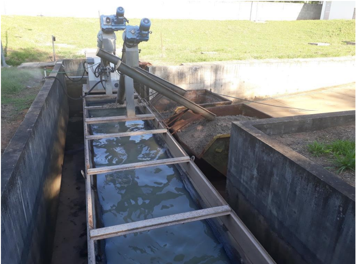
Figura 49- Peneiras rotativas autolimpantes e caixa de areia para retirada de sedimentos da ETE oeste de Adamantina.
