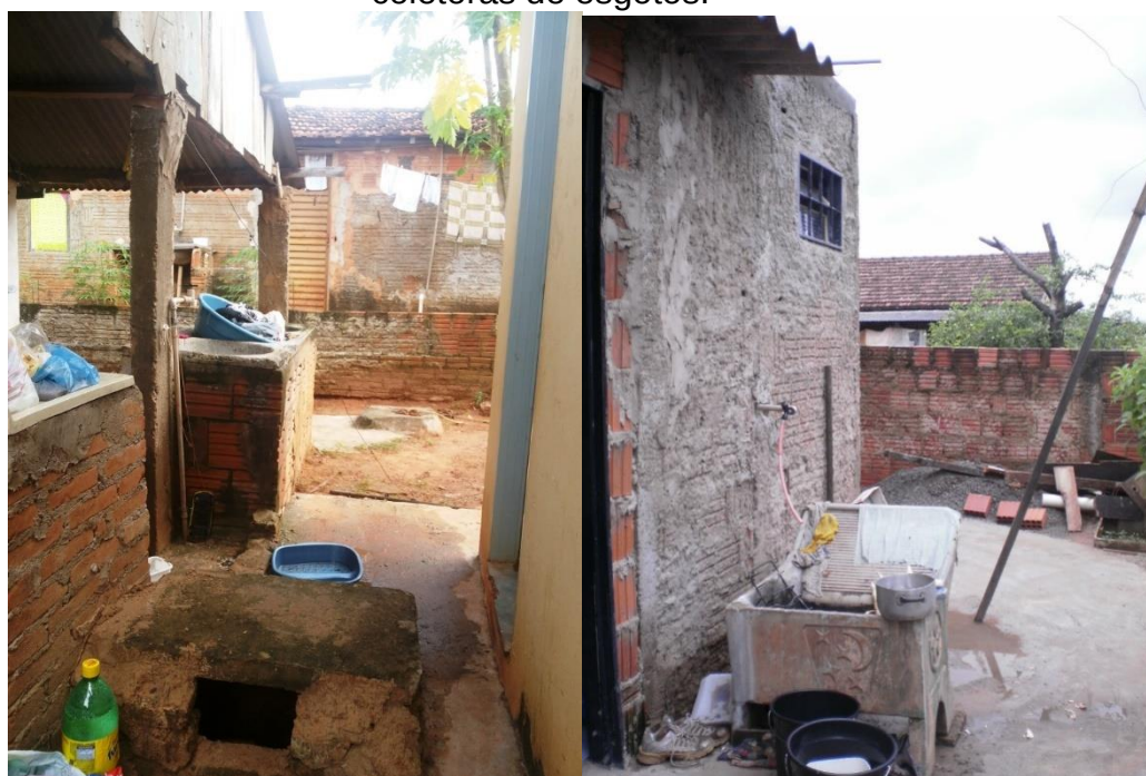
Figura 29 - Tanques descobertos que captam águas pluviais e conduzem para redes coletoras de esgotos.
