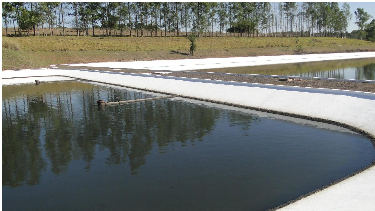
Figura 47- Tubulações entre a lagoa anaeróbia e facultativa da ETE leste de Adamantina.
