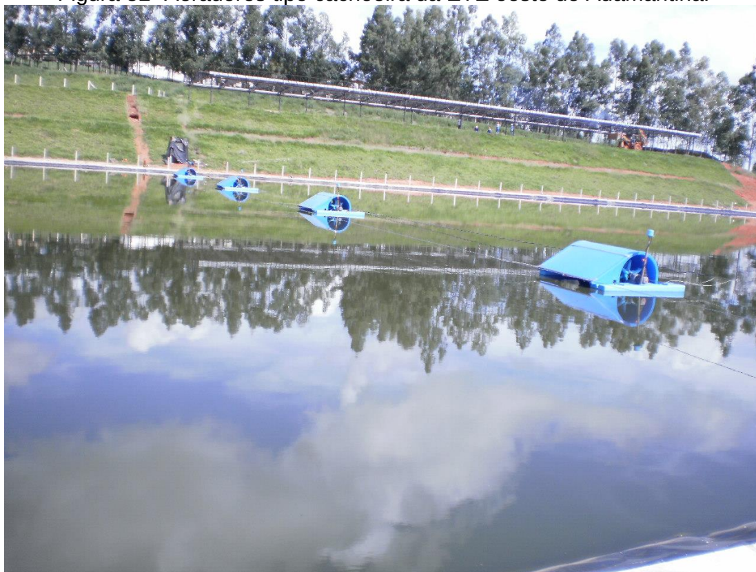
Figura 52- Aeradores tipo cachoeira da ETE oeste de Adamantina.
