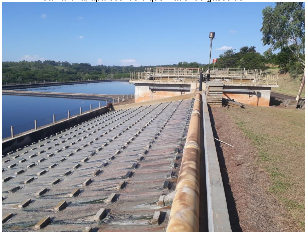
Figura 12 – Rampa de aeração entre o RAFA e as lagoas facultativas da ETE oeste de Adamantina, aparecendo o queimador de gases do RAFA.
