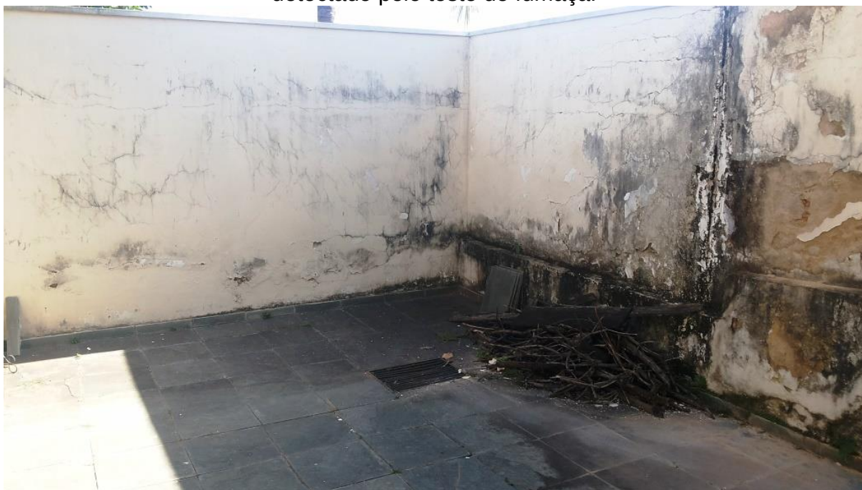
Figura 36 - Lançamento indevido de águas pluviais para as redes coletoras de esgotos detectado pelo teste de fumaça.
