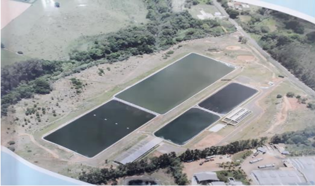
Figura 6- ETE oeste de Adamantina em operação.
