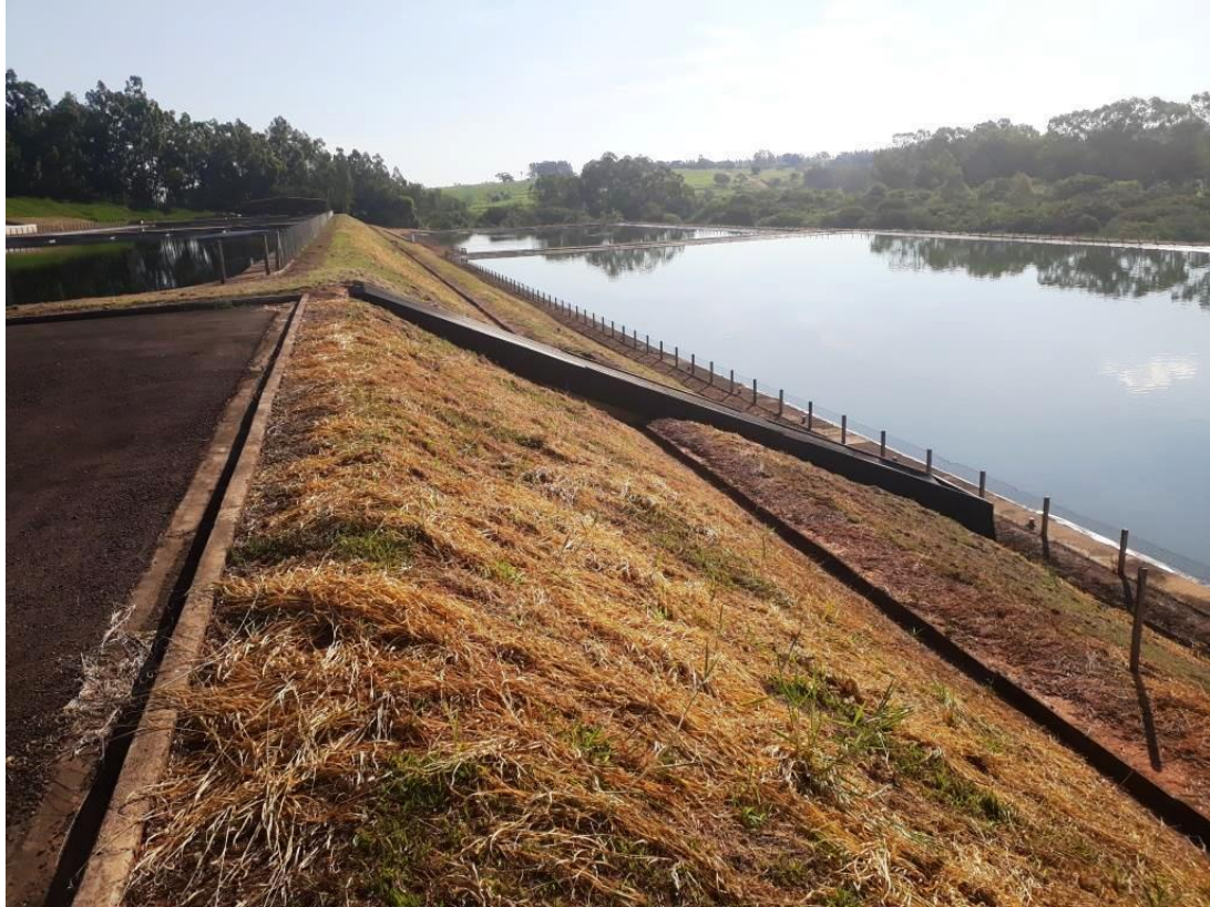
Figura 14 – Escada de aeração entre as lagoas facultativas da ETE oeste de Adamantina, aproveitando o desnível natural do terreno.
