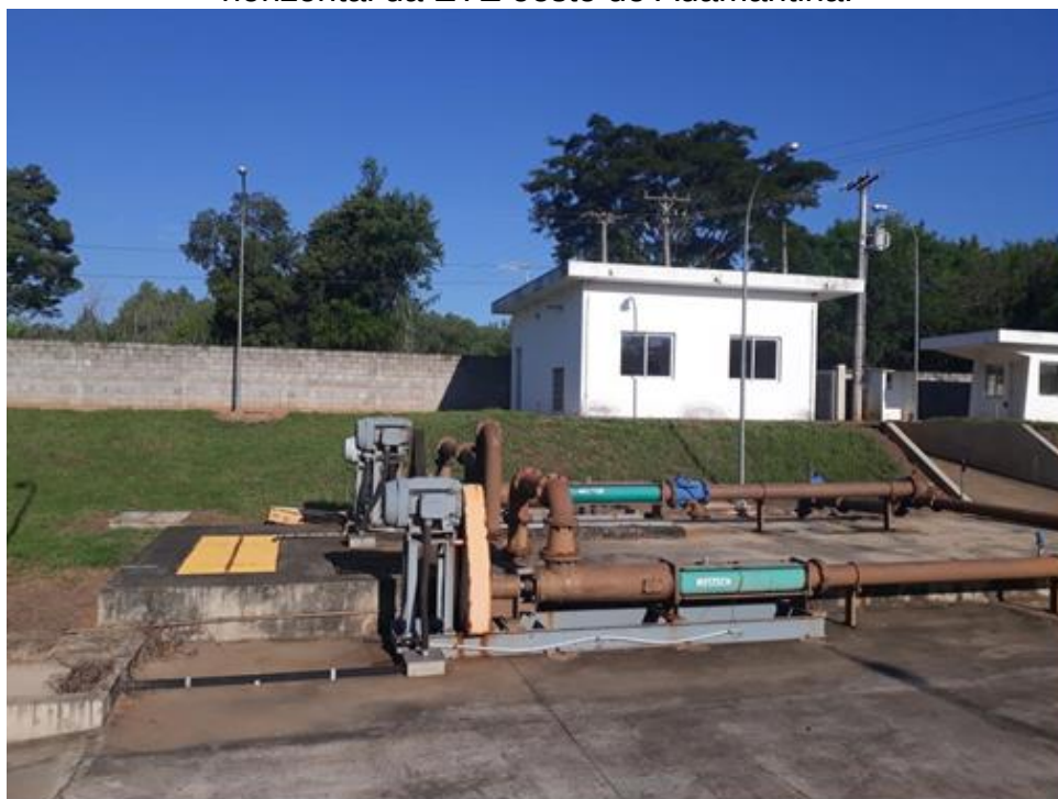
Figura 8- Estação de bombeamento de esgotos com bombas helicoidais de eixo horizontal da ETE oeste de Adamantina.
