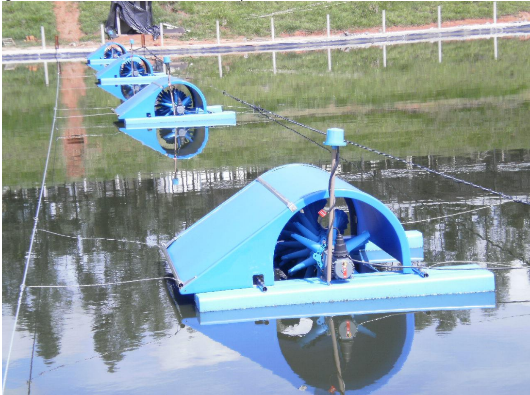
Figura 15 - Detalhe dos aeradores tipo cachoeira da ETE oeste de Adamantina.
