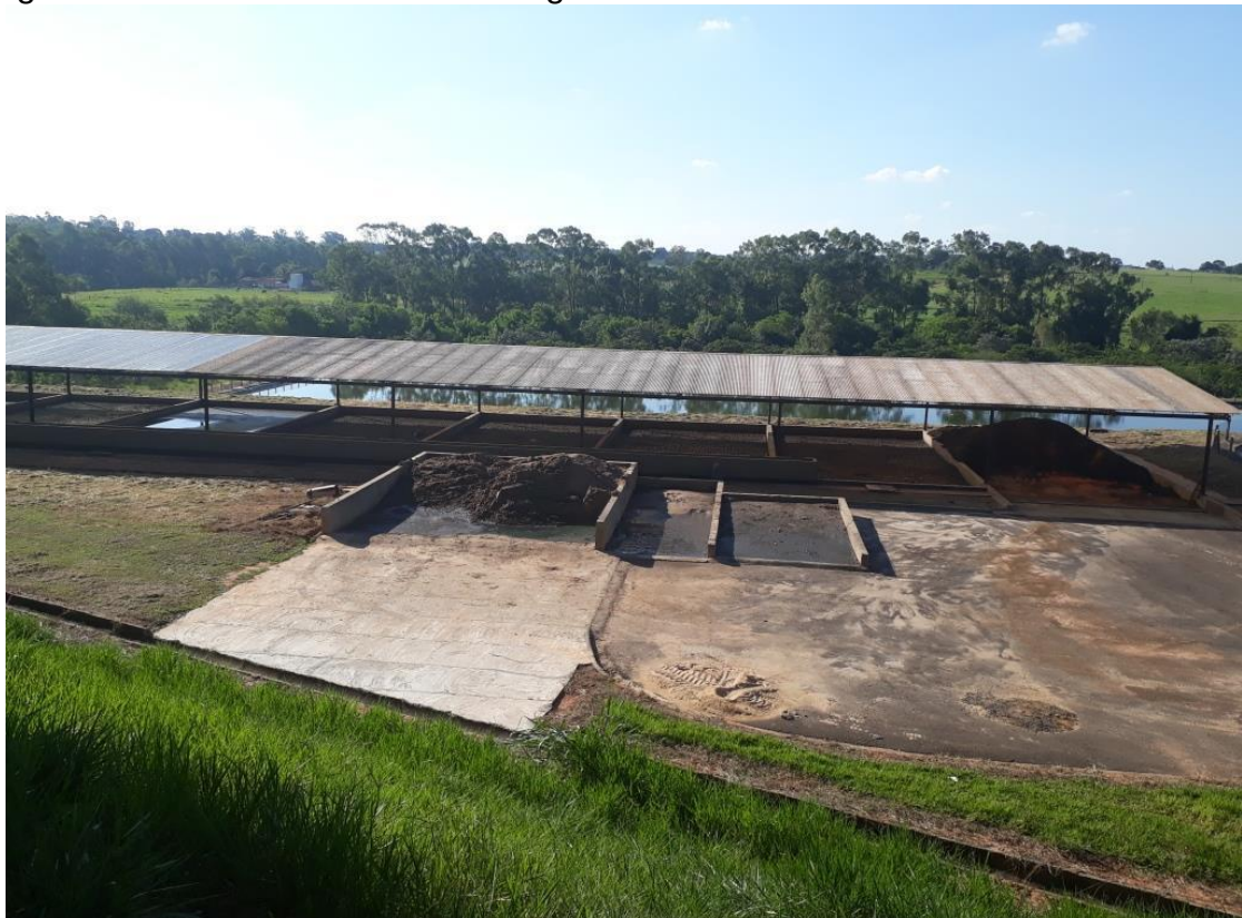
Figura 50 - Leitos cobertos de secagem dos lodos da ETE oeste de Adamantina.
