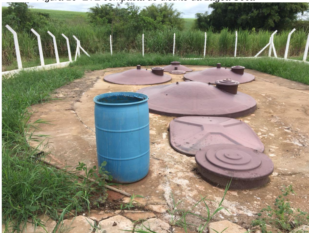
Figura 16–ETE compacta do distrito da Lagoa Seca
