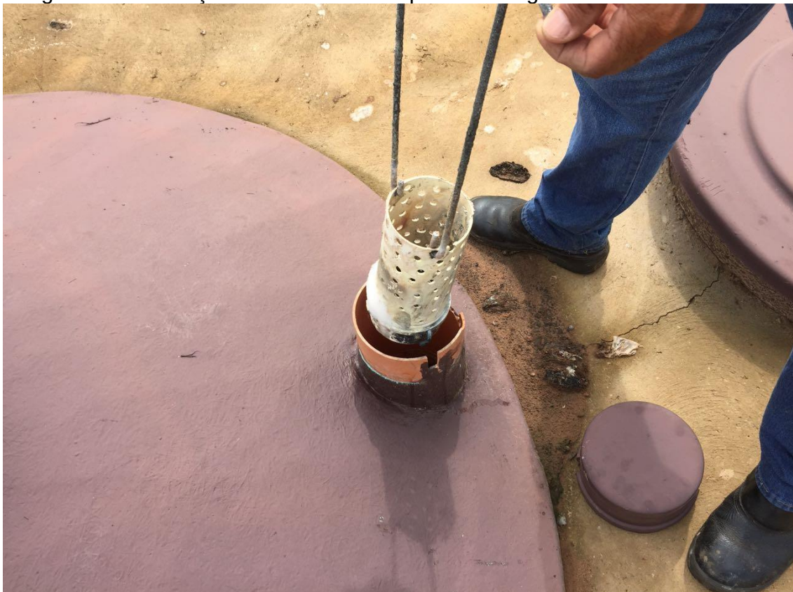
Figura 20 – Cloração final da ETE compacta da Lagoa Seca – Adamantina.
