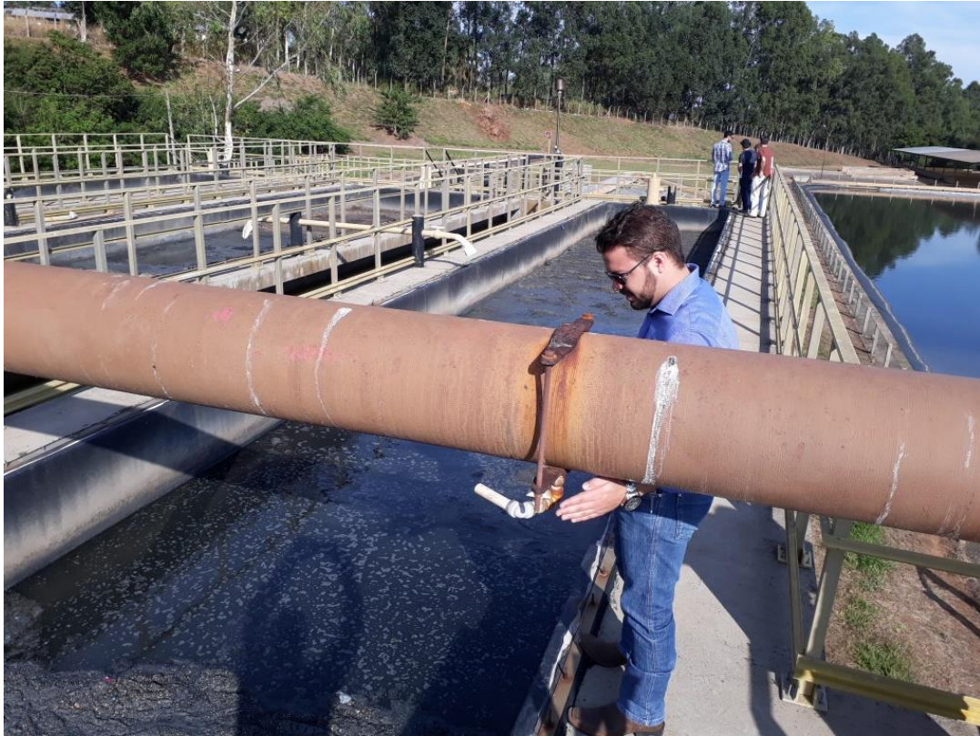
Figura 10 – Ponto de coleta de esgotos para análise no R.A.F.A. da ETE oeste de Adamantina.
