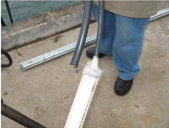
Figura 62: Borracha de Polietileno danificada
