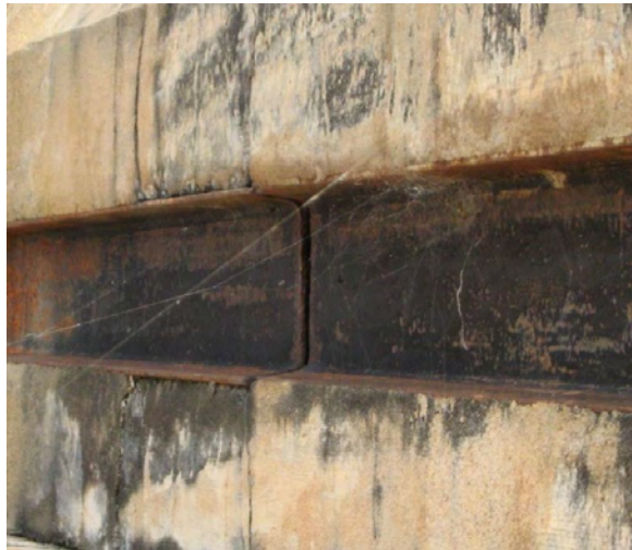
Figura 34: Deslocamento diferencial da guia metálica da grade (muro guia esquerdo)
