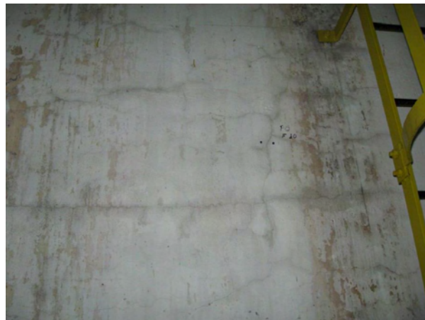
Figura 28: Fissurações aleatórias nas paredes internas da câmara do servomotor
