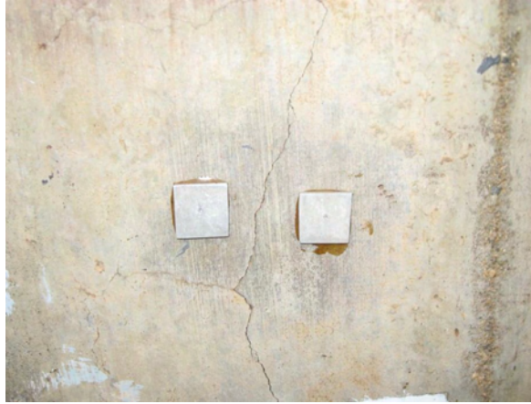
Figura 4: Conjunto de BT instalado em fissura
