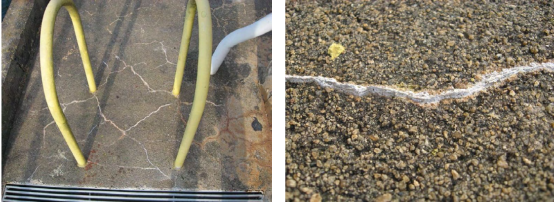
Figura 33: Exsudação de material branco de fissuras
