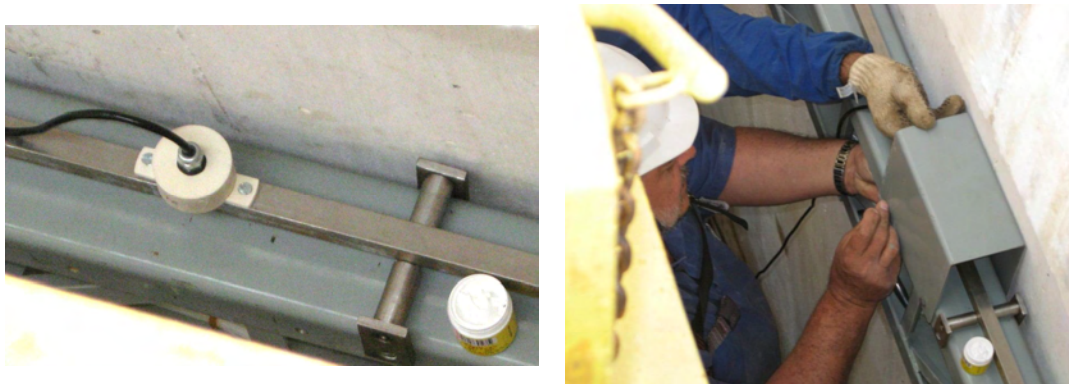
Figura 90: Termômetro instalado na barra de invar
