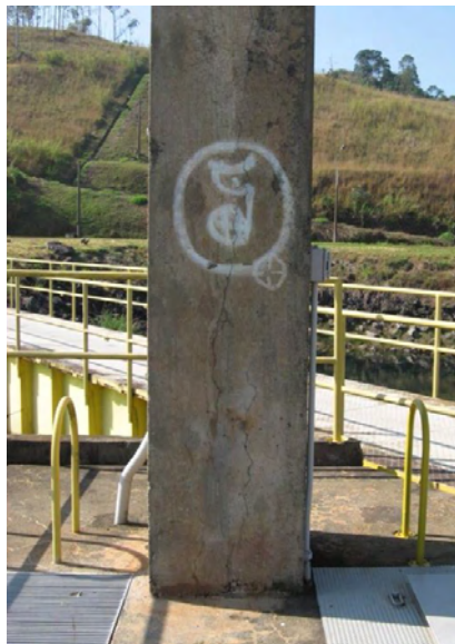
Figura 30: Fissuras verticais nos pilares
