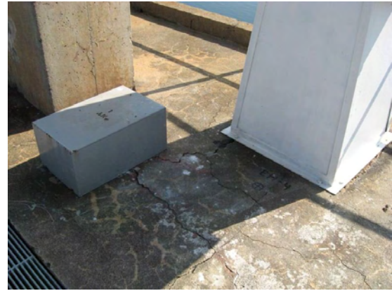
(b) Fissuras orientadas com aleatórias ao redor
