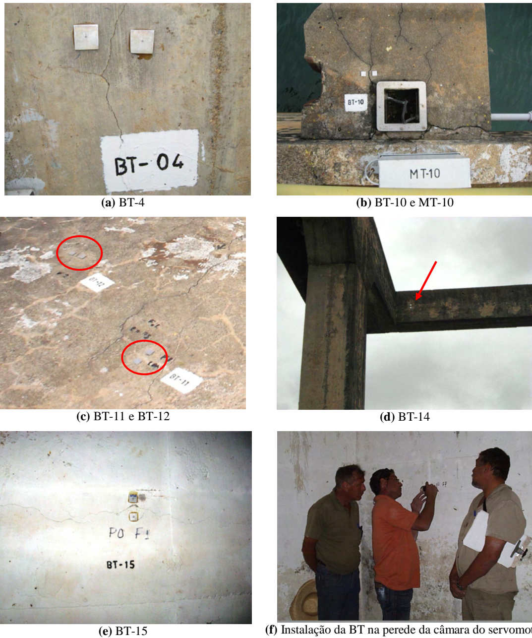
Figura 49: Bases para medição dos movimentos de fissuras instaladas na UHE Jaguari
