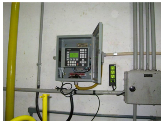
(b) Sistema de aquisição de dados funcionando
