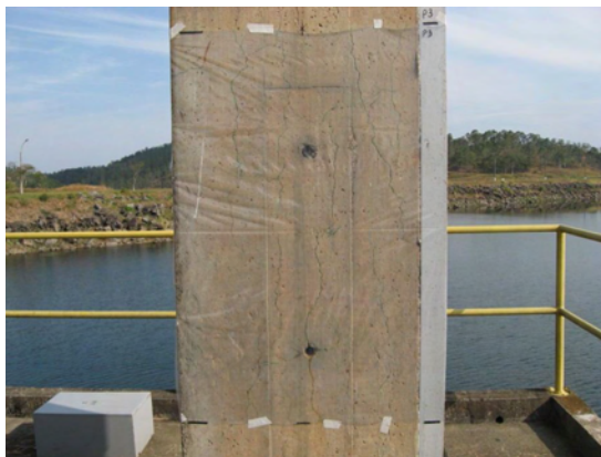
Figura 37: Mapeamento de fissuras no pilar
