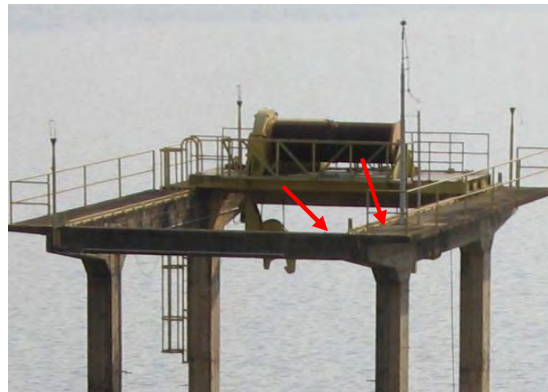
Figura 51: Localização das BT no pórtico de carga
