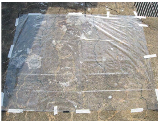
Figura 36: Mapeamento de fissuras na laje
