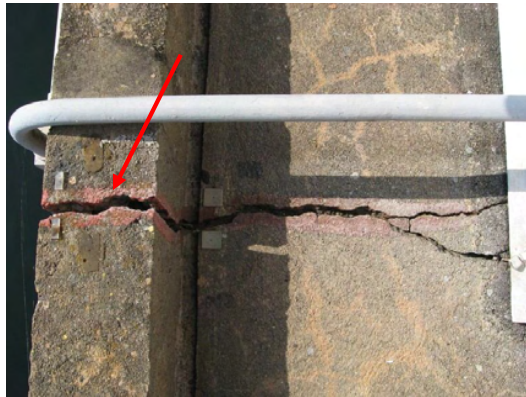
(a) Fissura onde foi instalado o MT-8
