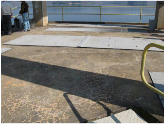
(a) Fissuras aleatórias
