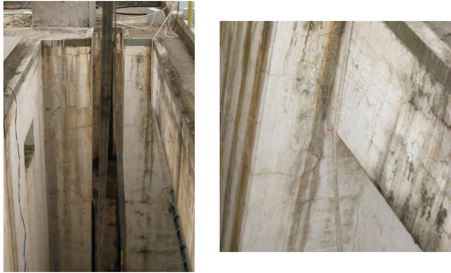
Figura 31: Fissurações nas paredes internas do compartimento do stop-log
