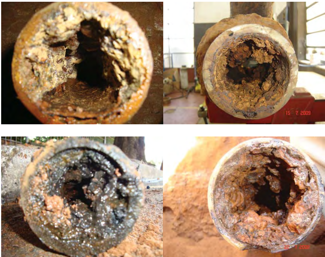
Figura 1: Amostras de pedaços de tubos de FoFo com incrustações retirados do sistema de abastecimento no município de Rio Claro – SP. (Fonte: DAAE - Departamento Autônomo de Água e Esgoto de Rio Claro).
