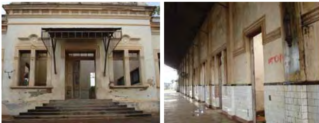
Figuras 27 e 28 – Estação ferroviária. Prédio deteriorado pelo abandono.
