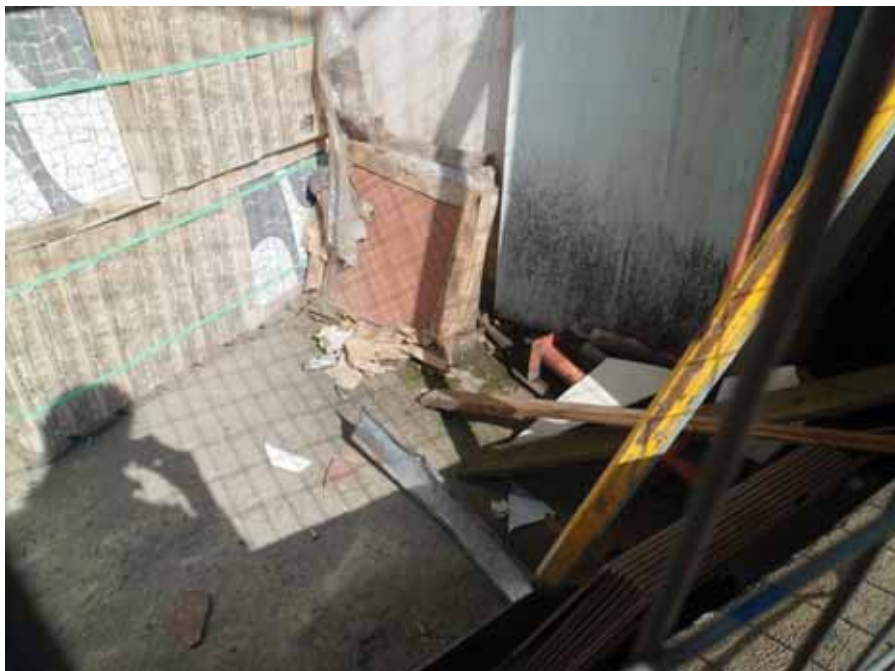
Figura 13- Acúmulo de sujeira nos cantos dos galpões.
