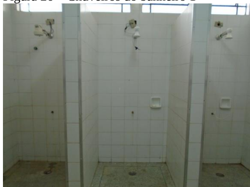
Figura 26 – Chuveiros do banheiro 1
