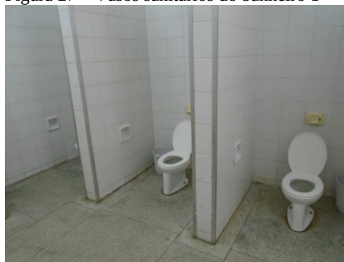
Figura 27 – Vasos sanitários do banheiro 1
