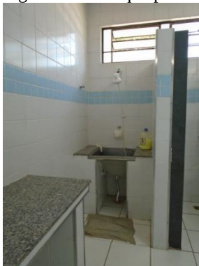
Figura 35 – Tanque para o banho
