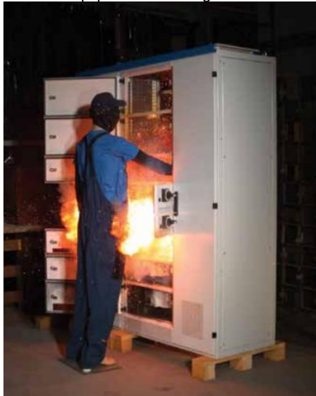
Figura 2 – Risco de exposição a arcos elétricos durante a operação de equipamentos energizados
