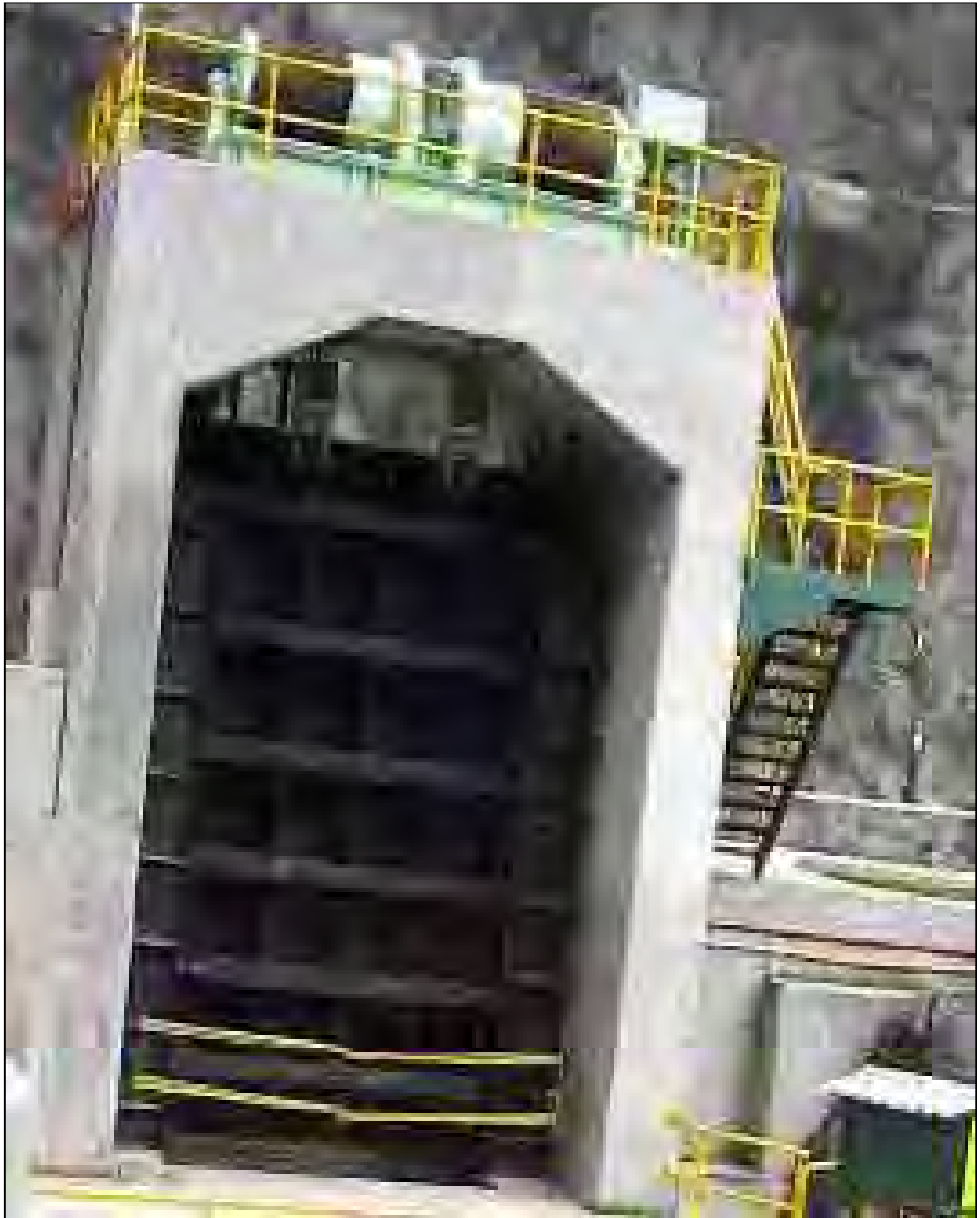
Figura 2 – Foto de uma Comporta Vagão em seu local de instalação.
