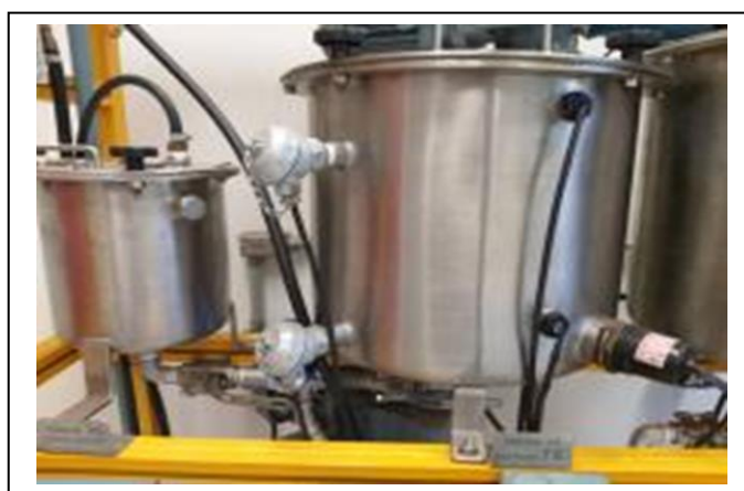
Figura 5 - Tanque de entrada com capacidade de 30 litros.
