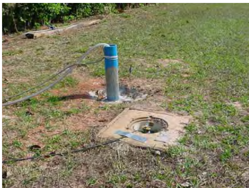
Foto 11 - Poço de bombeamento e monitoramento
