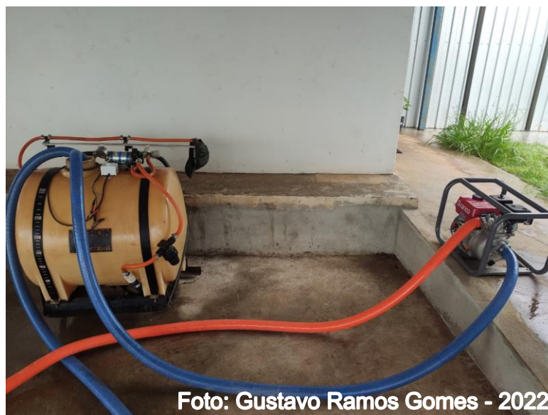
Figura 7 - Tanque de 300 litros para o abastecimento do sistema de fluxo conectado à motobomba pelas mangueiras de sucção
