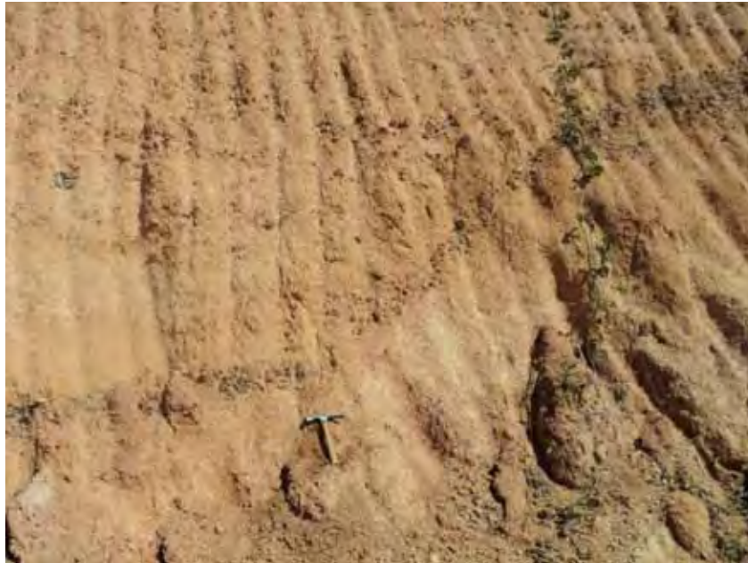
Figura 17: Falha normal deslocando a crosta laterítica em abatimento do bloco da esquerda.
