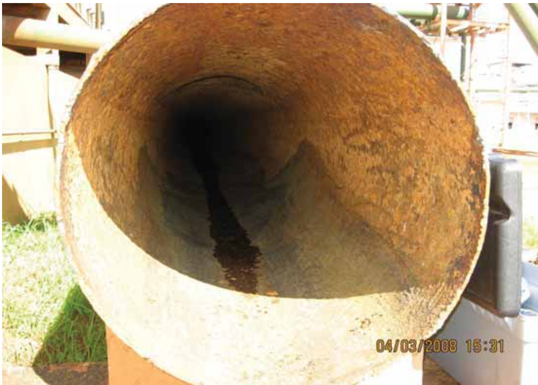
Figura 16: Tubulação de água de bruta, retorno da torre de resfriamento. Autor: Renato Vessecchi Lourenço
