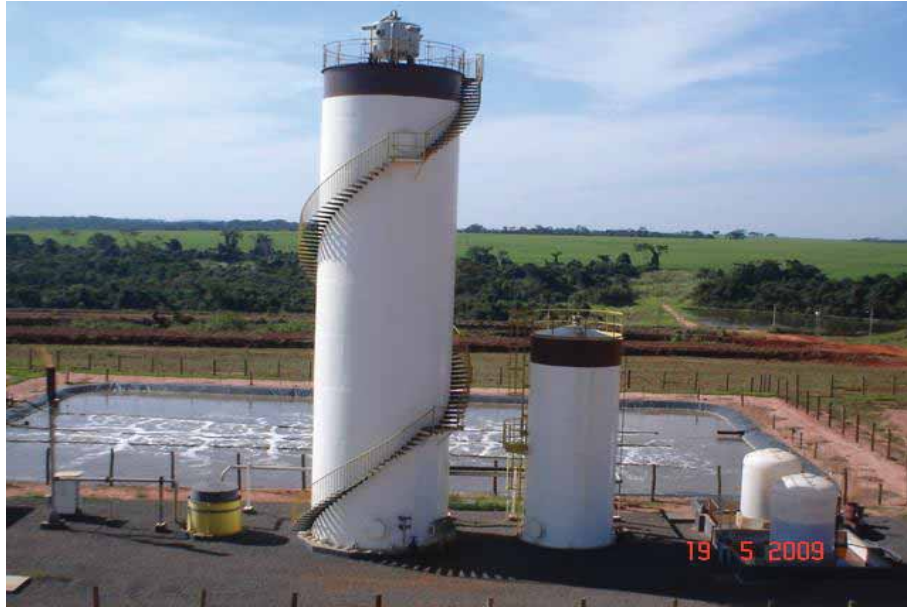
Figura 4: Sistema Anaeróbio Completo. Autor: Renato Vessecchi Lourenço.
