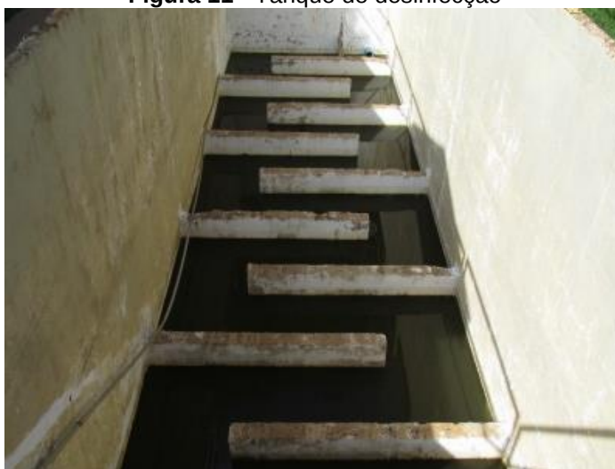
Figura 11 - Tanque de desinfecção
