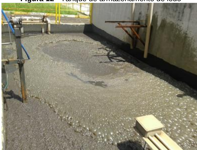
Figura 12 - Tanque de armazenamento de lodo
