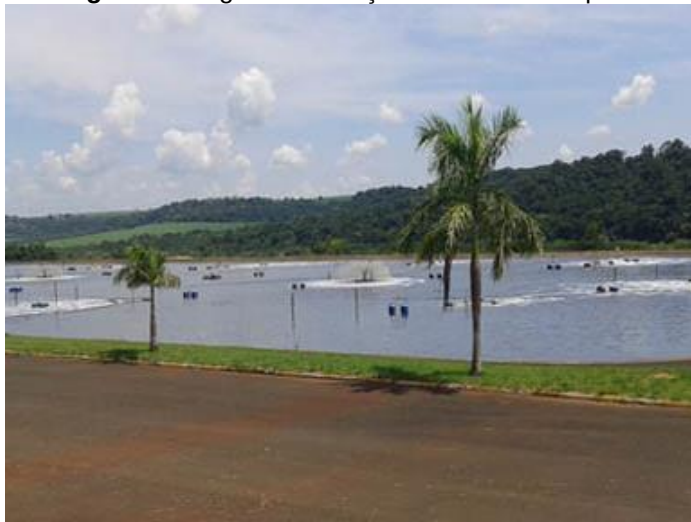
Figura 5 - Lagoa de Aeração da ETE Araraquara
