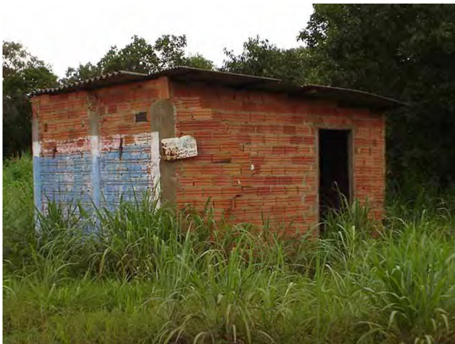
Figura 44: Quadra 605 Sul, ruínas do in concreto - construção abandonada. Fotografia tirada em 12 de janeiro de 2007.
