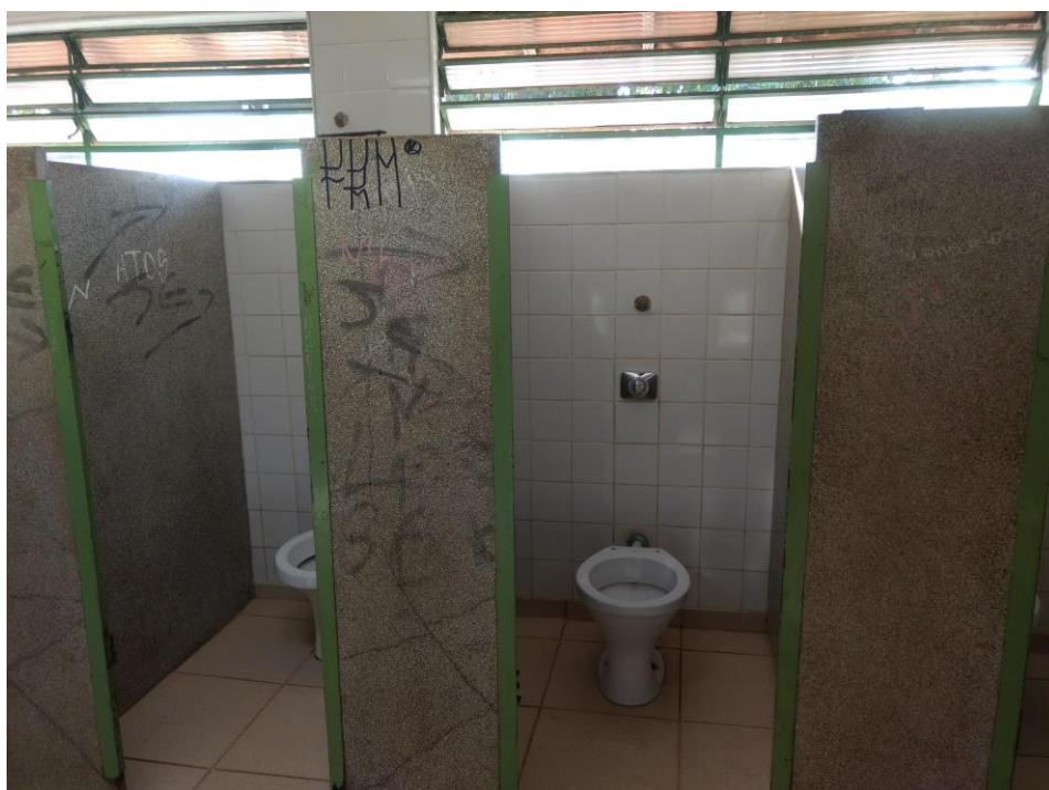
Figura 7 - Ausência de portas nos sanitários dos alunos
