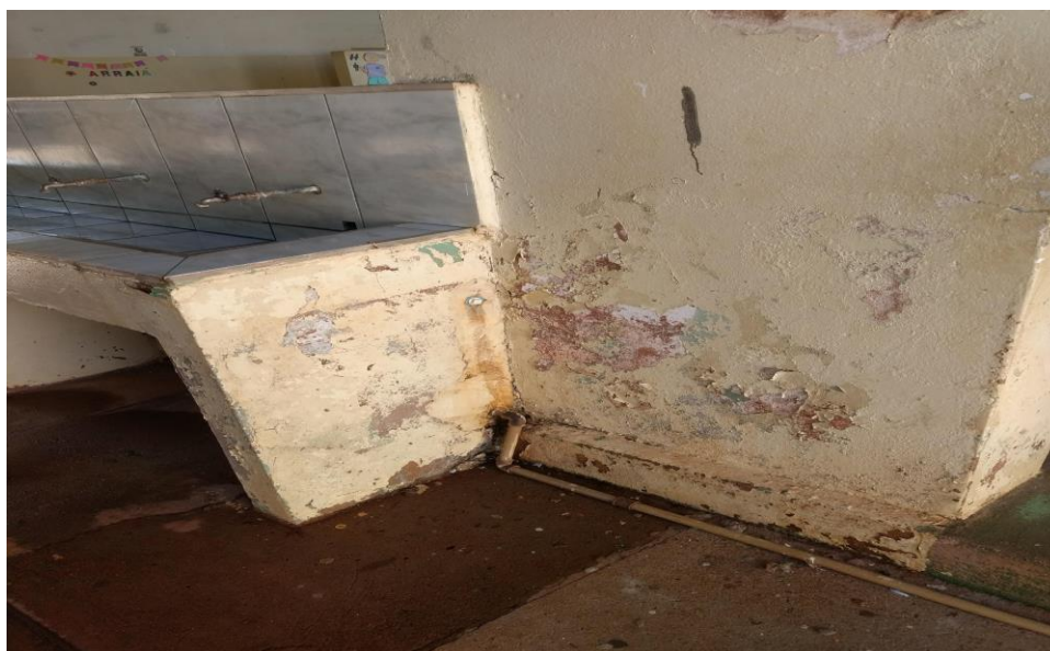
Figura 4 - Paredes do bebedouro do pátio com umidade e falta de manutenção
