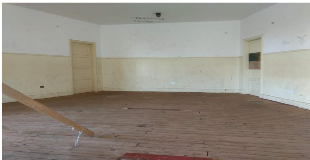
Figura 10 - Palco da escola desativado devido ao piso de madeira comprometido
