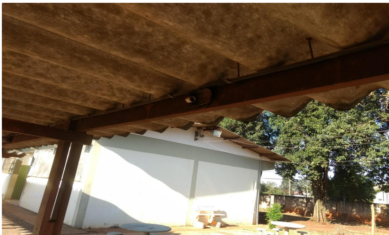
Figura 14 - Falta de iluminação na área externa
