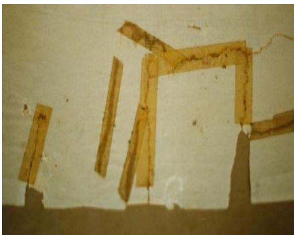
Imagem 8 – Intervenções inadequadas: fita adesiva
