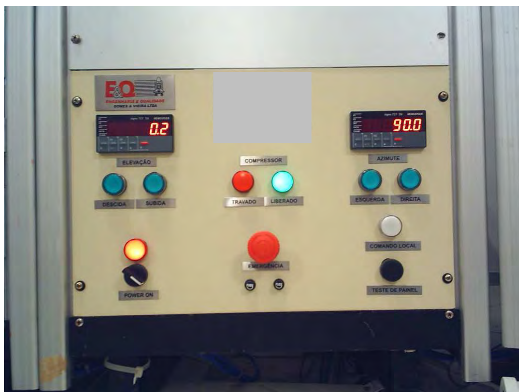
Figura 9 - Painel de comando do lançador
