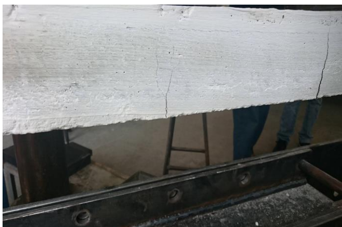
Figura 45 - Fissurações do lado oposto da viga à 0,26 tf.
