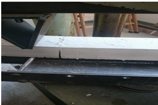
Figura 52 - Parte frontal da viga após rompimento.
