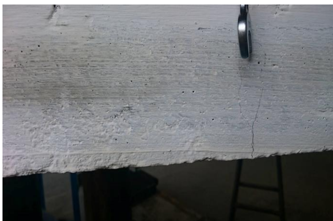
Figura 43 - Fissuração na parte oposta da viga à 0,09 tf.
