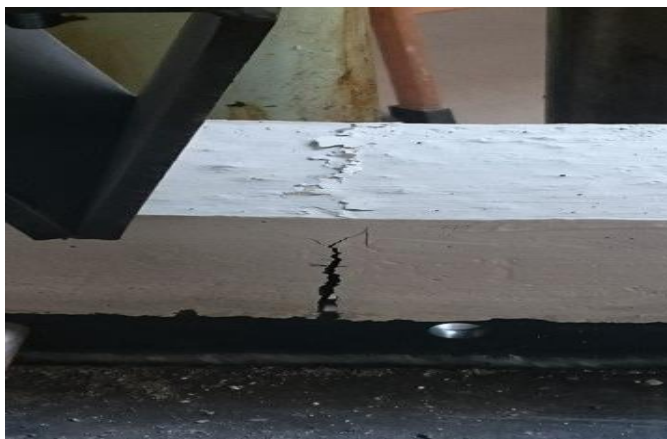
Figura 51 - Parte frontal da viga após rompimento.
