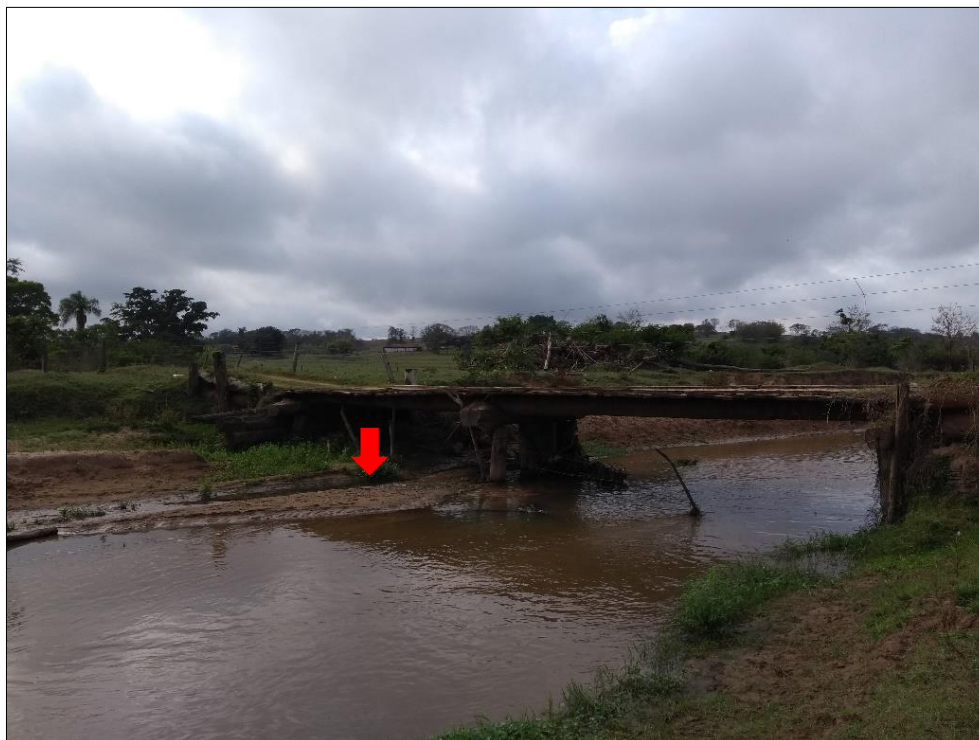
Figura 83. Trecho do rio Mandaguari no ponto RM4 no qual nota-se a presença de banco arenoso indicativo de assoreamento
