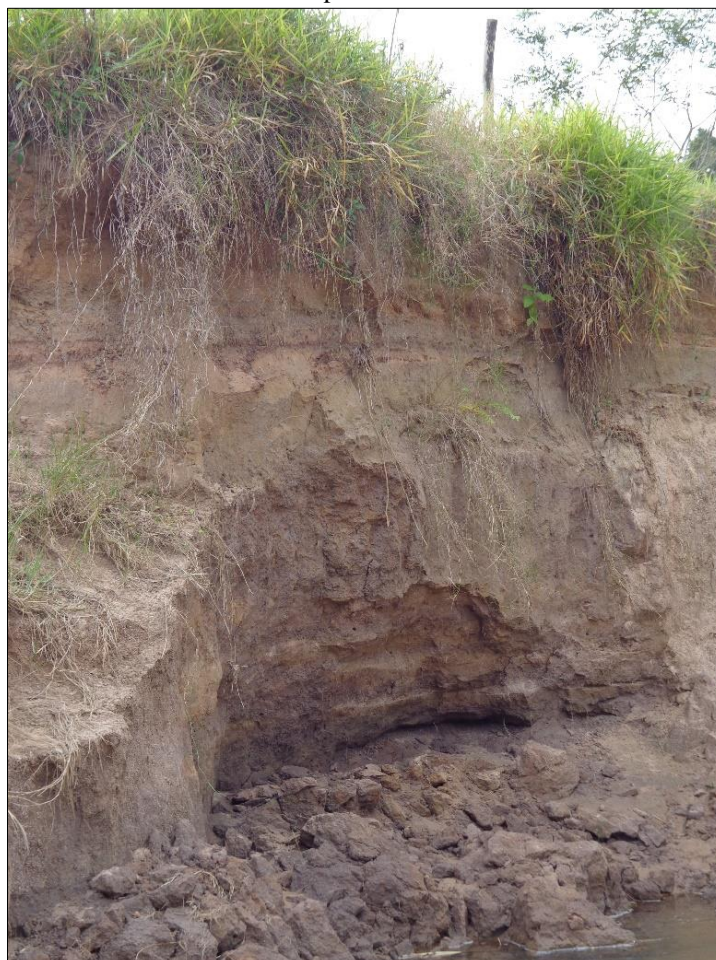
Figura 112. Ocorrência de solapamento basal em talude situado na margem direita do rio Mandaguari no trecho do ponto RM8
