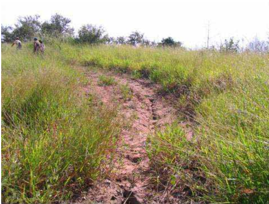
Figura 40: Sulcos erosivos no leito de uma estrada de terra construída inadequadamente na microbacia 1015 nas coordenadas UTM N=214.014,82m e E=7.511.669,586m.
