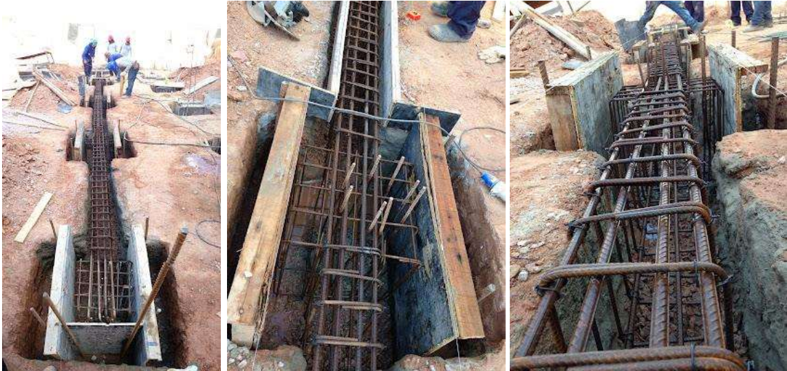
Figura 08 – Posicionamento das fôrmas e armaduras e ilustração do travamento dos blocos estruturais pela viga baldrame
