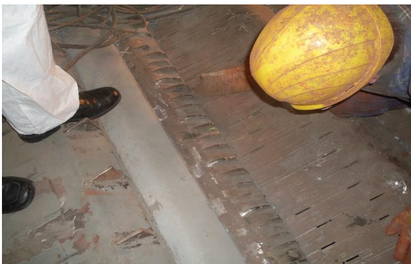
Figura 18 – Interior da câmara de incineração (em manutenção) – grelhas móveis com aberturas
