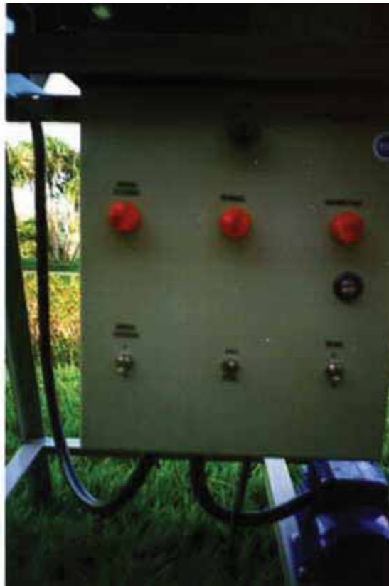
Figura 7 - Detalhe do painel eletrônico de comandos.
