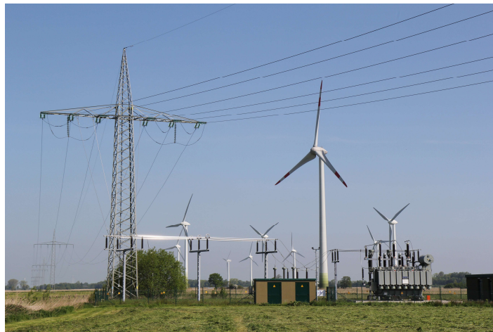
Figura 3.4 – Subestação e linha de transmissão de 110 kV em usina eólica na Alemanha.
