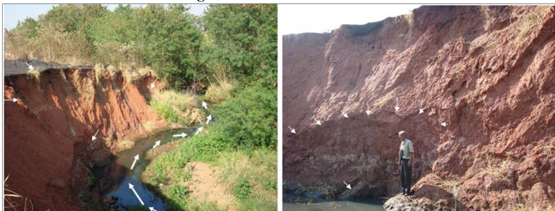
Figura 31. Erosão “A” em detalhe
