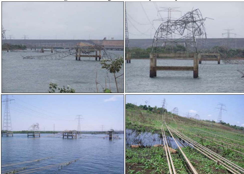
Figura 25. Estragos causados pelo temporal
