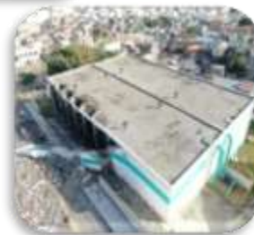
Rompimento de Tanque de Água São José/ 2023
