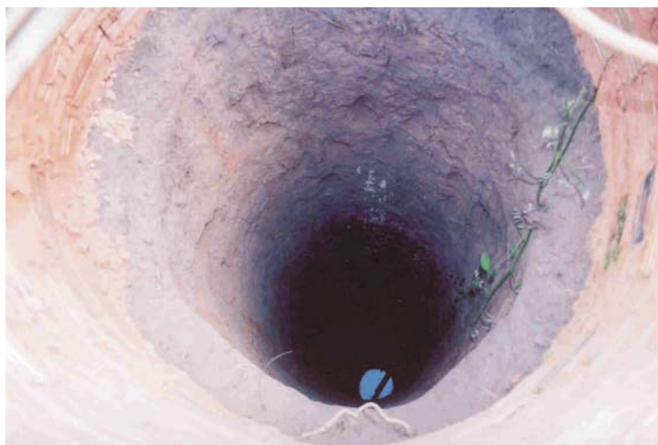
Foto 17 Sedimento cinza escuro (rico em matéria orgânica) correlacionavel com os sedimentos arenosos da Formação Botucatu. Modelo construtivo de poço escavado sem revestimento, facilitando os processos de poluição.
