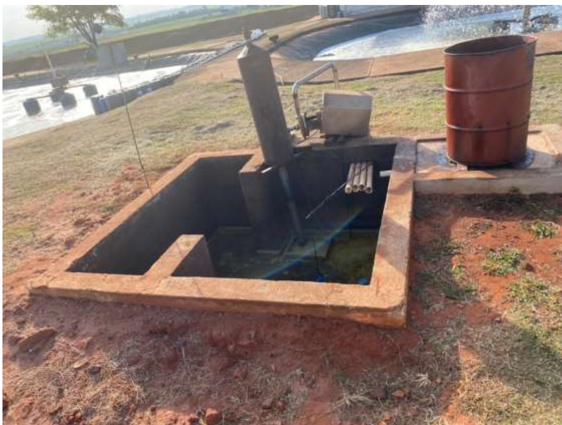
Figura 12. Caixa de areia
