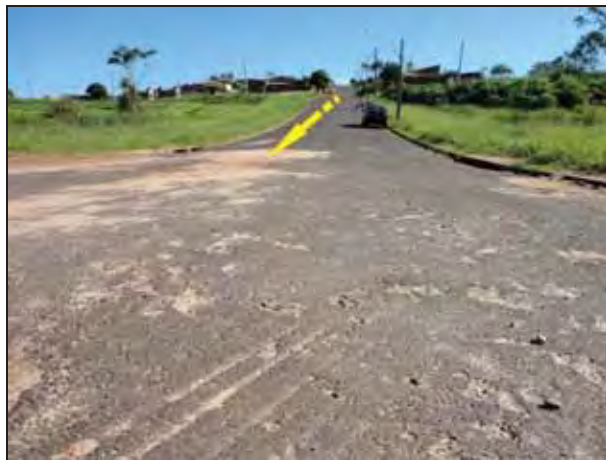
Figura 26: Sedimentos acumulados na última rua do Parque Residencial Francisco Belo Galindo, próximo à planície aluvial na qual foi retirada a amostra de depósito tecnogênico.
