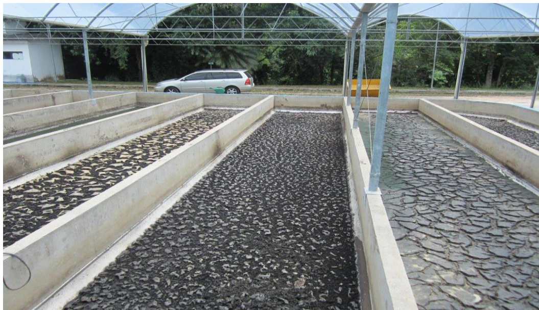
Figura 69 - Leito de secagem adaptado com piso de blocos drenantes na ETE em Ubatuba.
