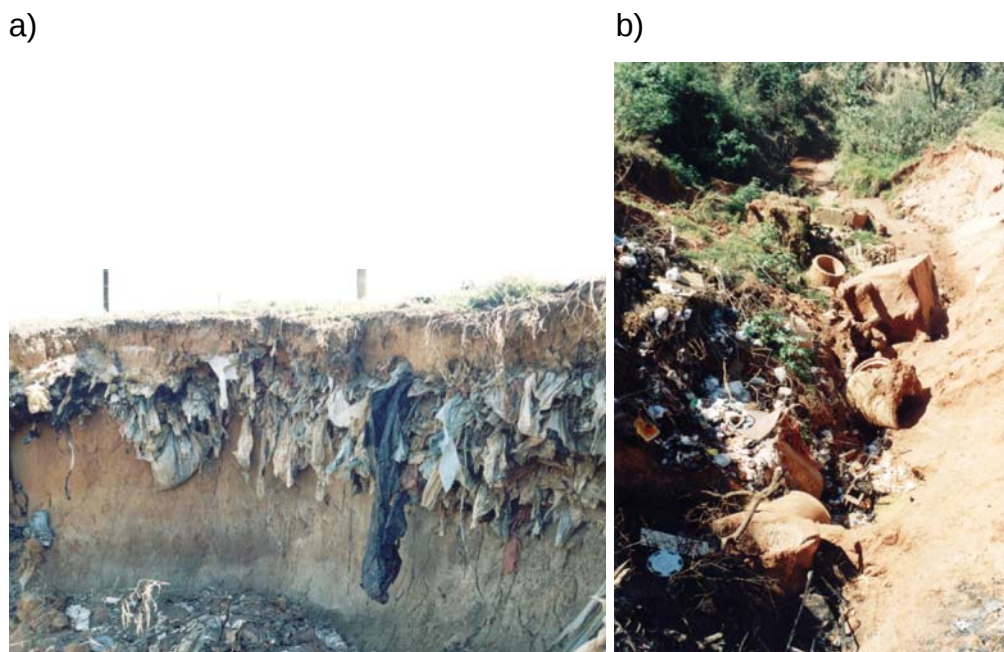
Figura 43: erosão na Pousada da Esperança (a) e no Córrego Barreirinho (b)
