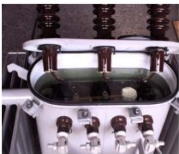
Figura 4 – Óleo isolante do transformador
