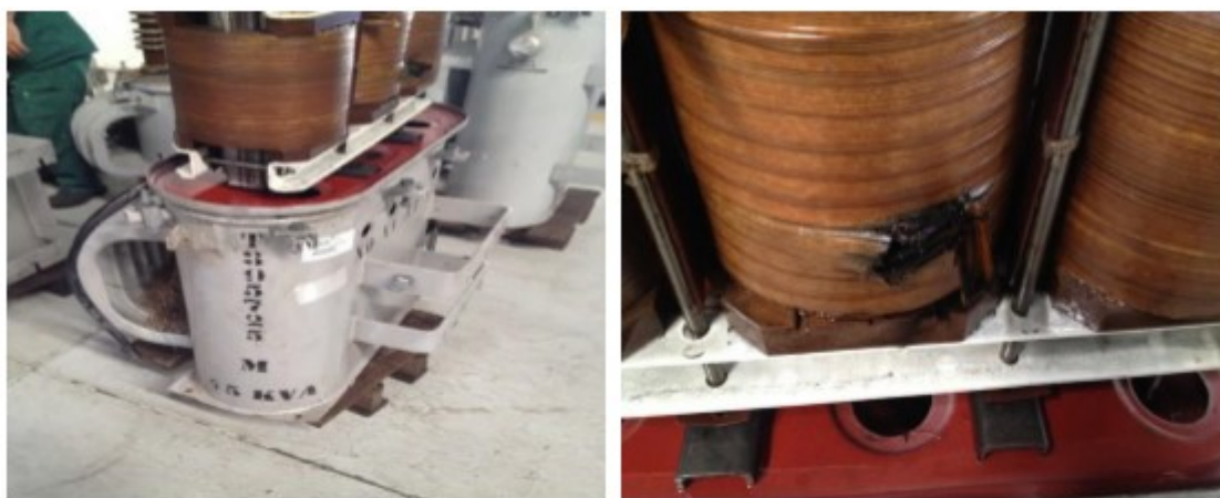
Figura 8 – Transformador que sofreu queima por curto-circuito interno
