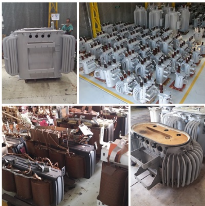
Figura 7 – Transformadores enviados para a Reformadora
