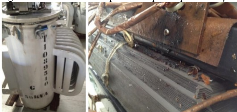
Figura 11 – Transformador que sofreu queima por infiltração de água
