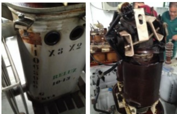
Figura 10 – Transformador que sofreu queima por sobrecarga
