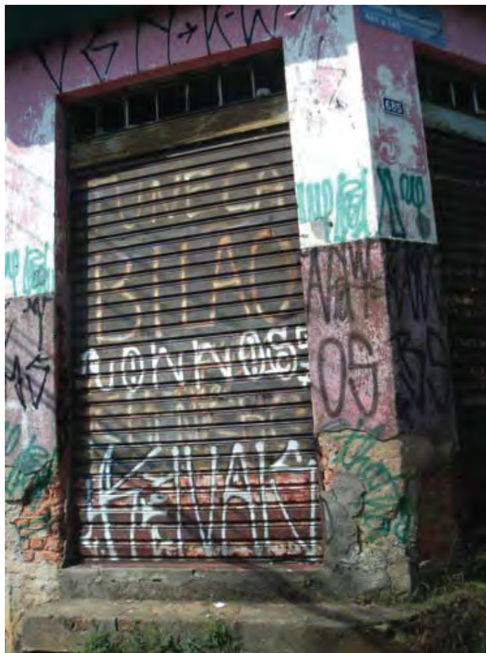
Figura 33: Fachada totalmente pichada. Fotógrafo e data desconhecidos.
