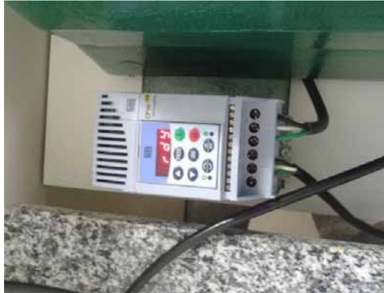
Figura 49- Inversor de Frequência CFW-08, usado para controle de velocidade e torque do disco principal da máquina de polimento.
