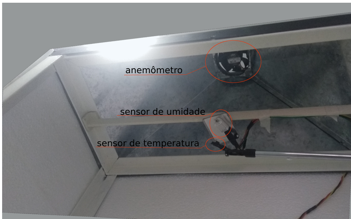
Figura 4.29: Sensores da região 5 e 6, duto de saída do ar aquecido. Vista do interior, sentido do fluxo de ar saindo da câmara de secagem para a saída do equipamento. Fonte: Autor (2021).
