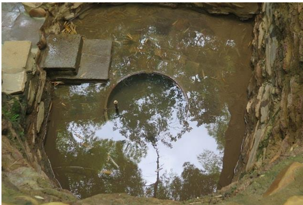
Figura 122 - A água do rio Pirapitinga invade as barreiras construídas para preservar os poços termais e acaba inundando-os. Fonte: https://muitaviagem.com.br/destino/caldas-novas/
