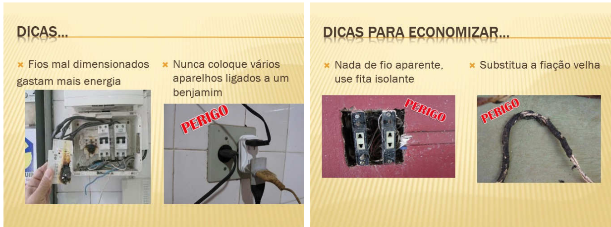
Figura 6.4 – Ilustrações referentes aos perigos de uma má utilização de condutores e terminal “tê”.
