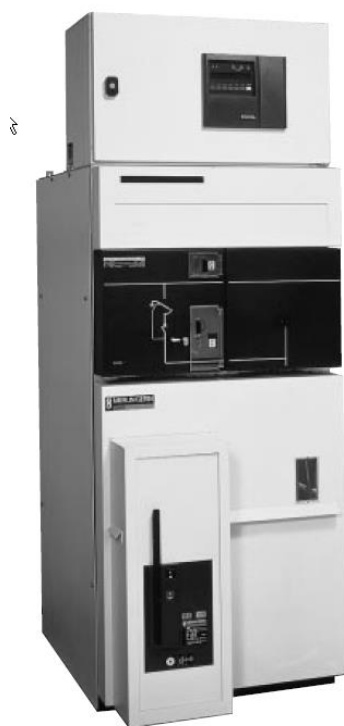
Figura 3 - Conjunto constituído de um painel SM6 com um controlador programável SEPAM, ambos produtos da Schneider Electric
