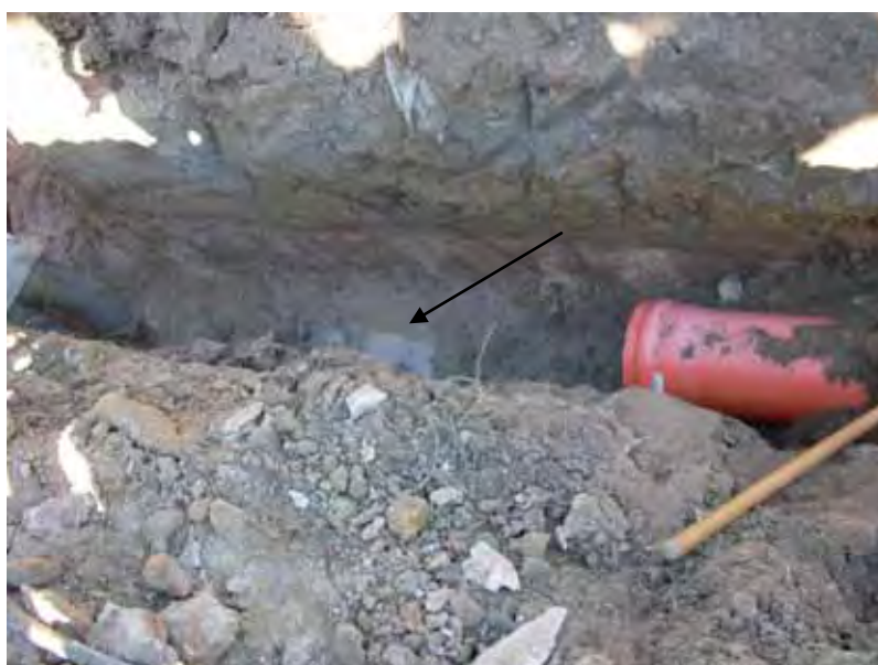
Figura 10: Perfuração sobre a Formação Marília para passagem de tubulação do Sistema de Afastamento de Esgoto. Nota-se o afloramento do aquífero freático.
