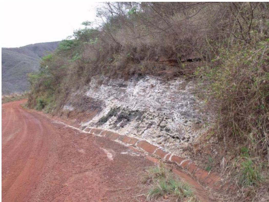
Figura 7.5.2_1 – Afloramento com a ocorrência de sulfatos na região da barragem da Usina de Irapé, indicando o intemperismo dos sulfetos e a liberação de enxofre da rocha
