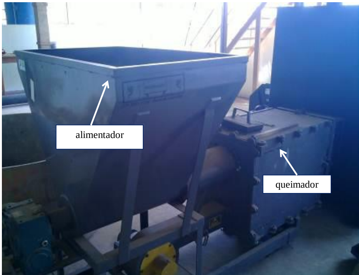
Figura 13 – Sistema de queima de biomassa - queimador acoplado a um alimentador de biomassa
