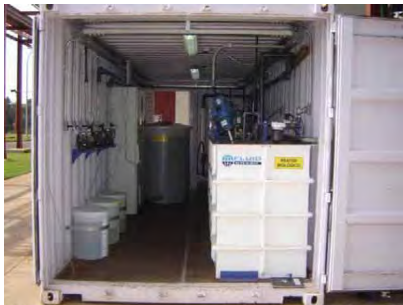
Figura 5.3: Vista frontal do protótipo piloto de MBR
