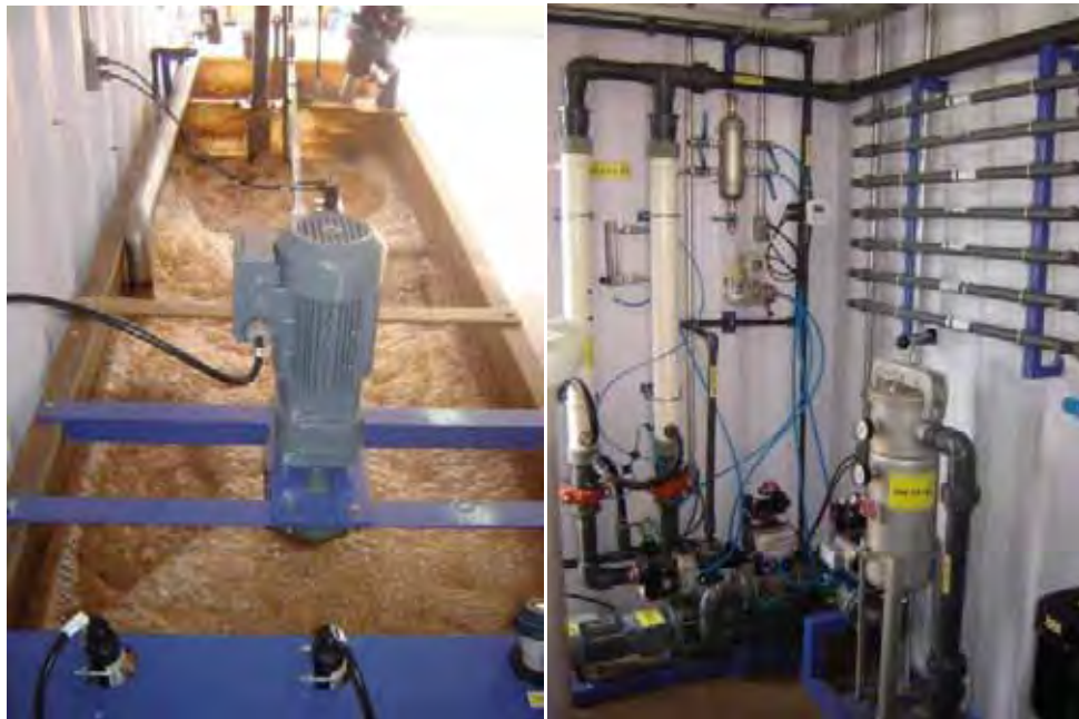
Figura 5.4: Vista superior do reator aeróbio e detalhe do sistema de ultrafiltração
