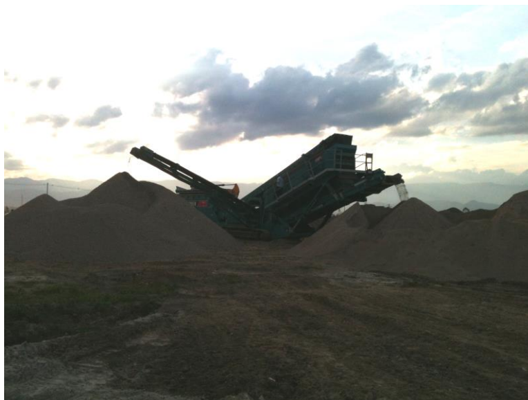
Figura 3 – Peneiras para separação/classificação granulométrica dos agregados em Pindamonhangaba (SP).
