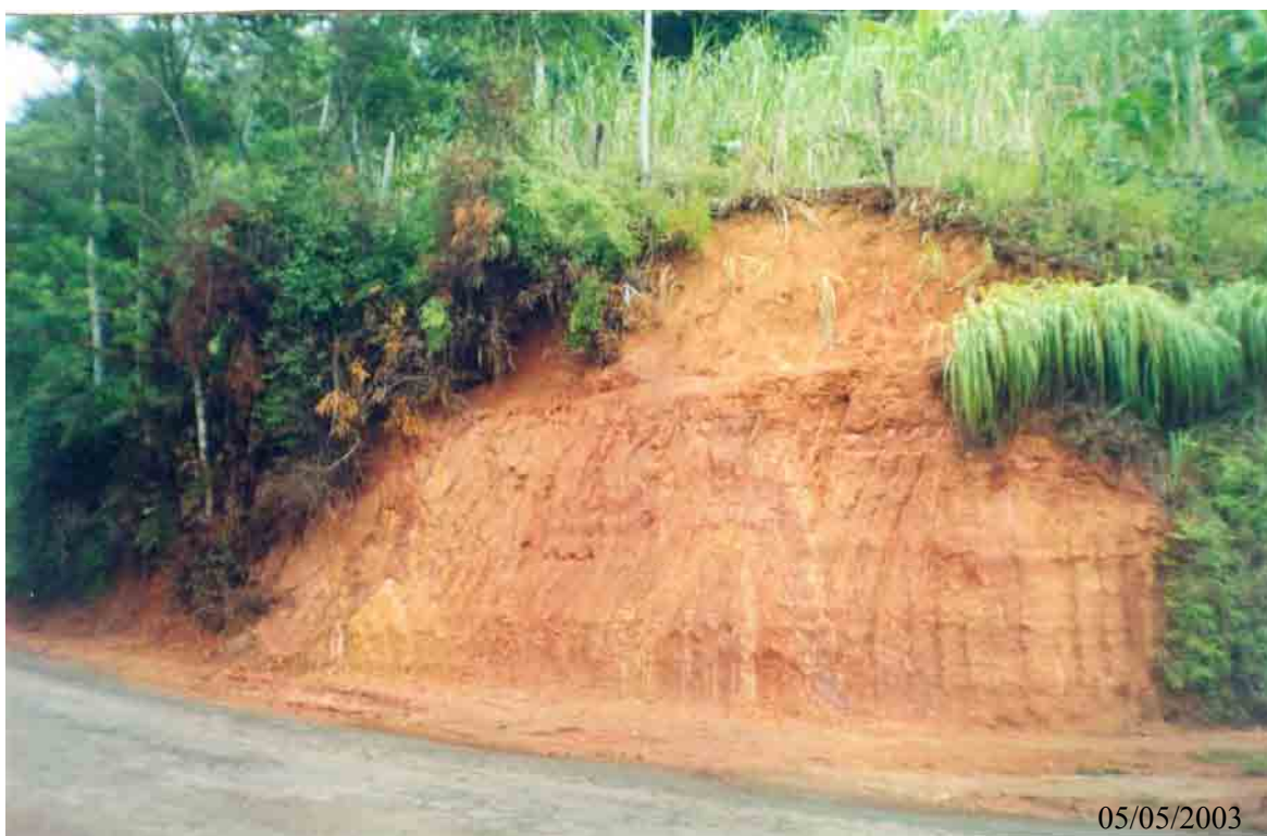
Figura 54 – P 3d – Aspecto da área de deslizamento depois da limpeza executada para desobstrução da estrada do Guaraú, Jardim Guaraú, no município de Peruíbe.
