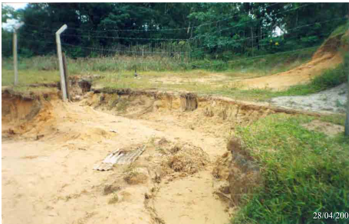
Figura 25 – I 5e – Aspecto da erosão na margem direita do rio Itanhaém, chácara localizada na avenida Benedito Antonio Muniz, nº 1315, Jardim dos Imigrantes, no município de Itanhaém.
