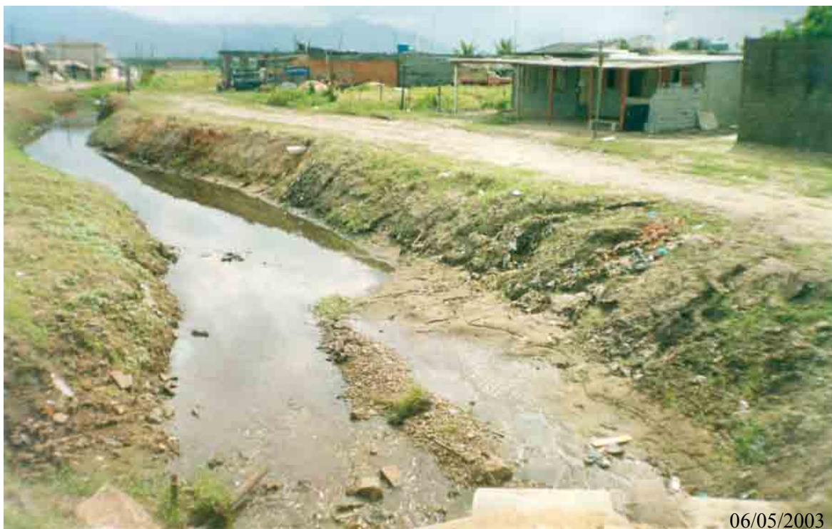
Figura 55 – PG 1i – assoreamento das margens do rio Acaraú, bairro Jardim Quietude, no município de Praia Grande.
