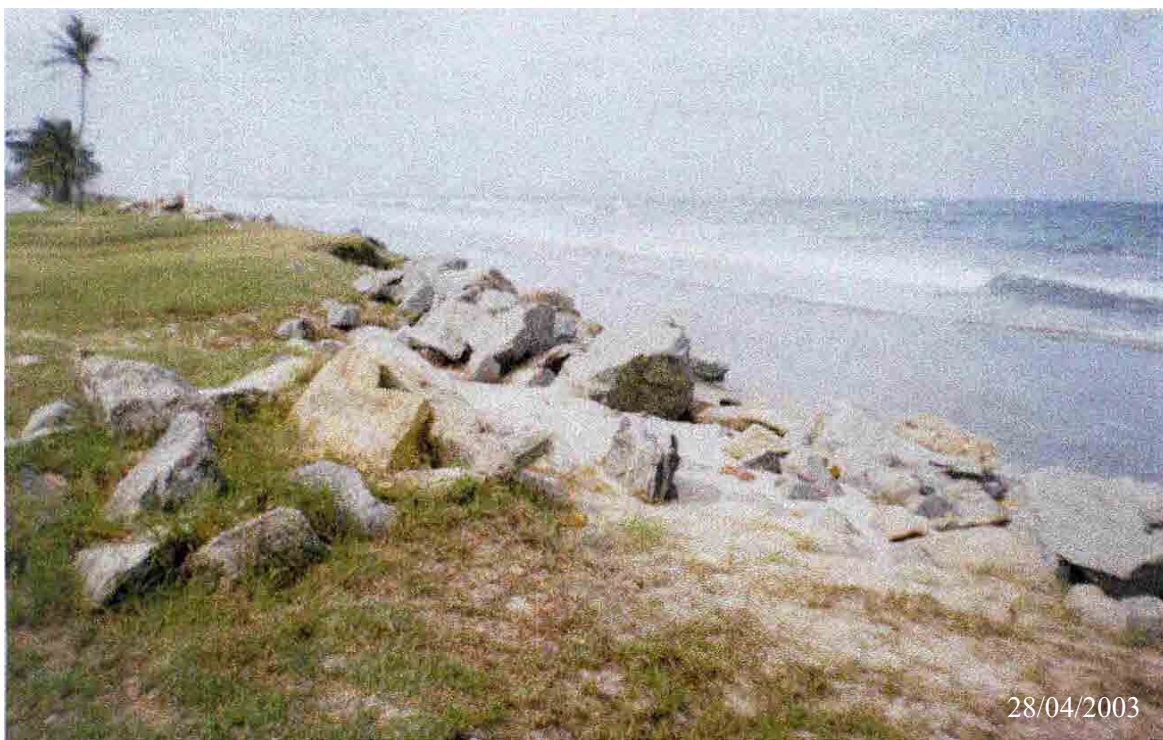
Figura 15 – I 1e – Aspecto do enrocamento de proteção danificado, localizado na Praia do Centro, no município de Itanhaém.
