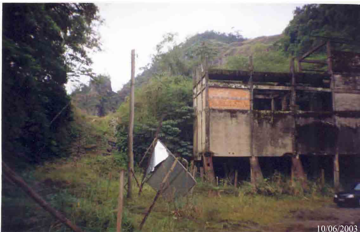
Figura 38 – M 4d – Aspecto de deslizamento da encosta. Cava em “V”, utilizada para drenagem do lago formado pelo rebaixamento da Pedreira Mongaguá. Estrada do Poço (lado morro), no município de Mongaguá.
