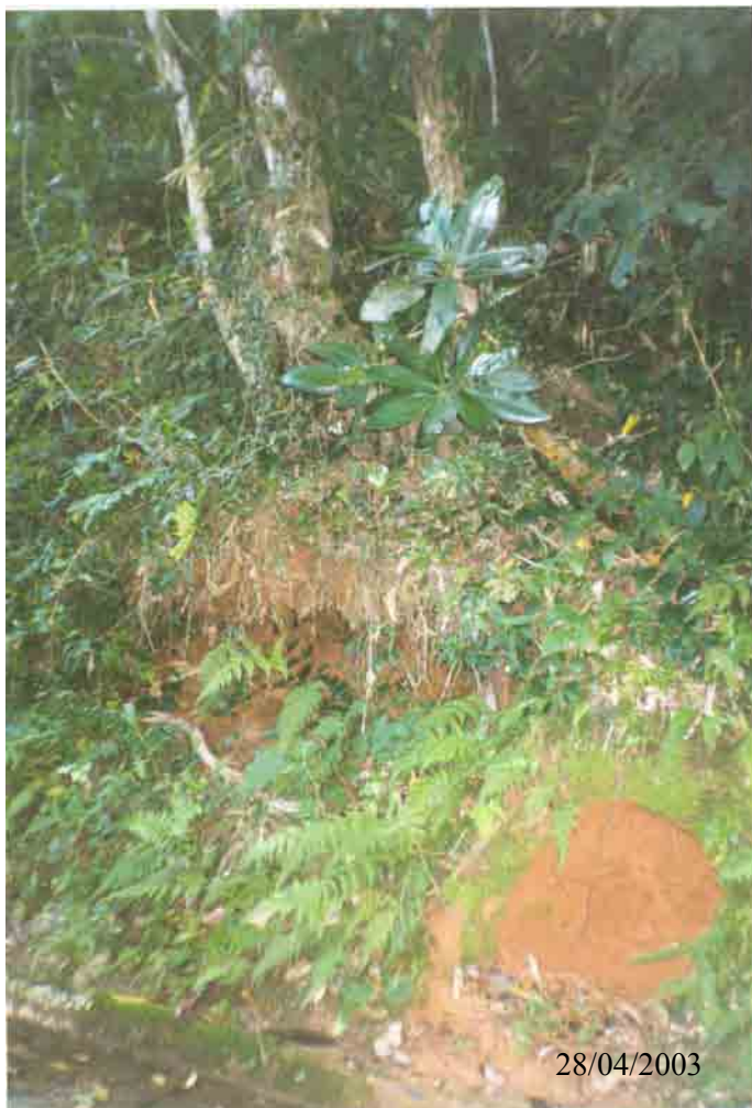
Figura 19 – I 2d – Cicatriz de deslizamento expondo raízes da vegetação localizada junto à via de acesso do reservatório de água da SABESP, morro da Praia do Sonho (lado da praia), no município de Itanhaém.
