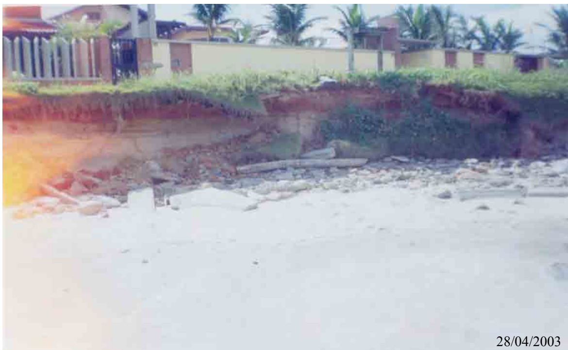
Figura 17 – I 1e – Residências em risco por processos erosivos, no cruzamento entre a avenida Dr. José Peixe Abade e a rua Profª Dinorah Cruz, no município de Itanhaém.
