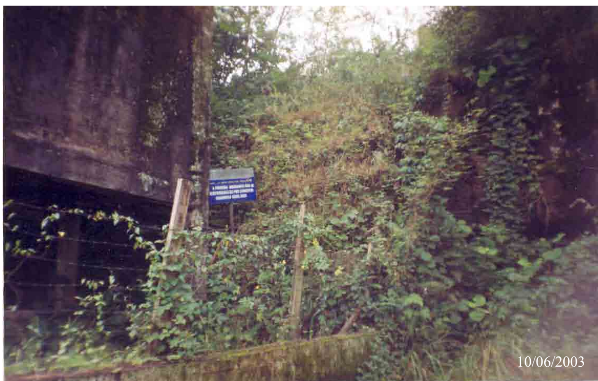
Figura 36 – M 4d – Placa com indicação de risco a população colocada em local desapropriado. Pedreira Mongaguá, estrada do Poço, no município de Mongaguá.
