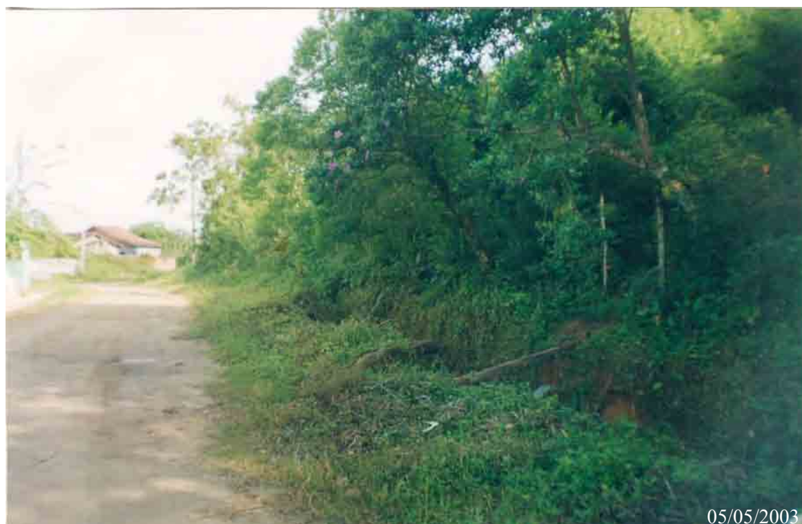
Figura 34 – M 3d – Encosta onde a vegetação apresenta troncos de árvores inclinados, evidenciando a movimentação do solo junto à avenida Embaixador Pedro de Toledo, Jardim Aguapeú, no município de Mongaguá.
