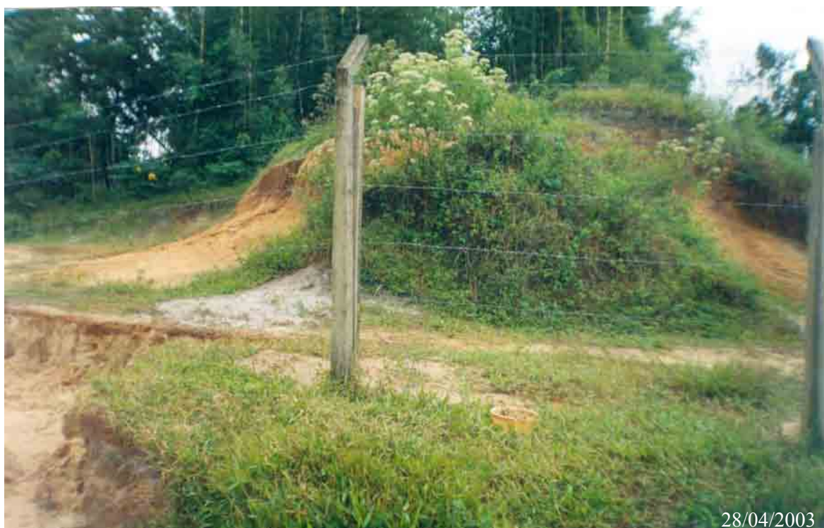
Figura 26– I 5e – Área erodida na margem direita do rio Itanhaém, chácara localizada na avenida Benedito Antonio Muniz, nº 1315, Jardim dos Imigrantes, no município de Itanhaém.
