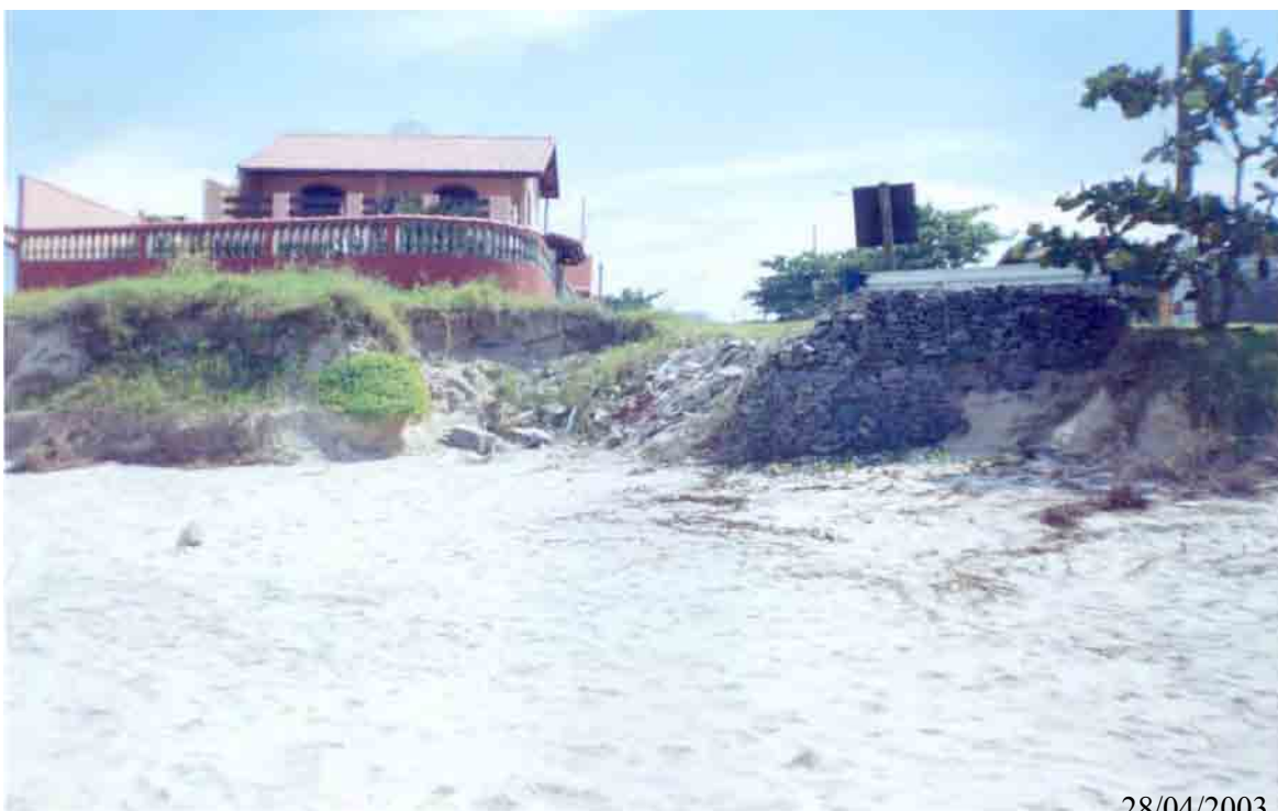
Figura 16 – I 1e – Residência em risco a erosão, gaiola de gabião rompida, no cruzamento entre a avenida Dr. José Peixe Abade e a avenida Carlos Gomes de Camargo, no município de Itanhaém.
