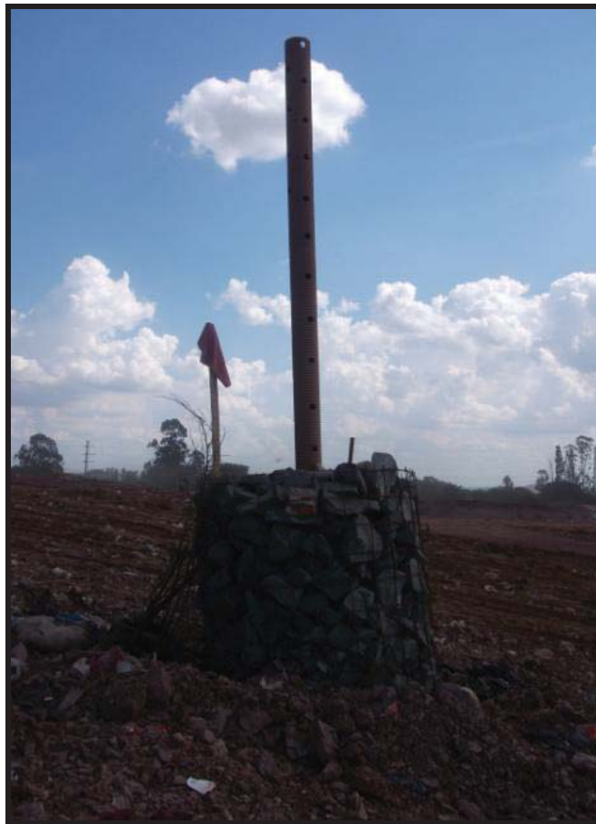
Figura 14. Imagem de um dos drenos de biogás na fase de construção, nos quais não foi possível medir o biogás.
