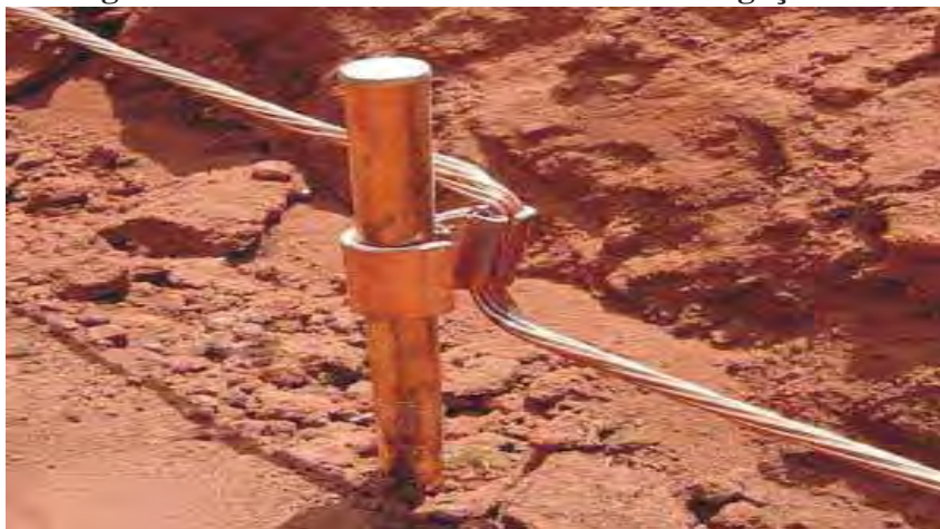
Figura 6 - Haste de aterramento e cabo de ligação.
