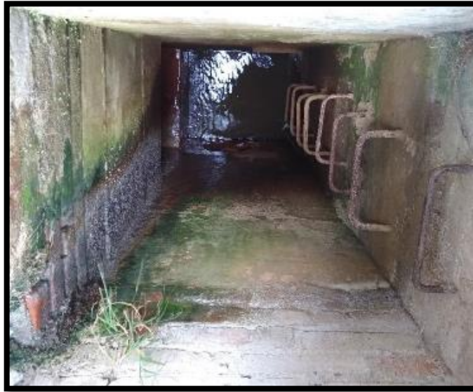
Figura 10 - Câmara de inspeção onde convergem as duas drenagens dos decantadores.
